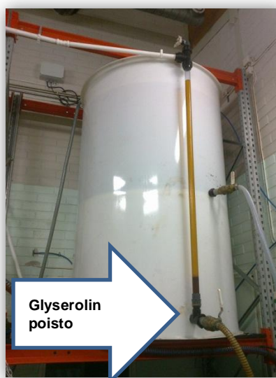
Kuva 5. Glyserolin poistovennttiin sijainti.
