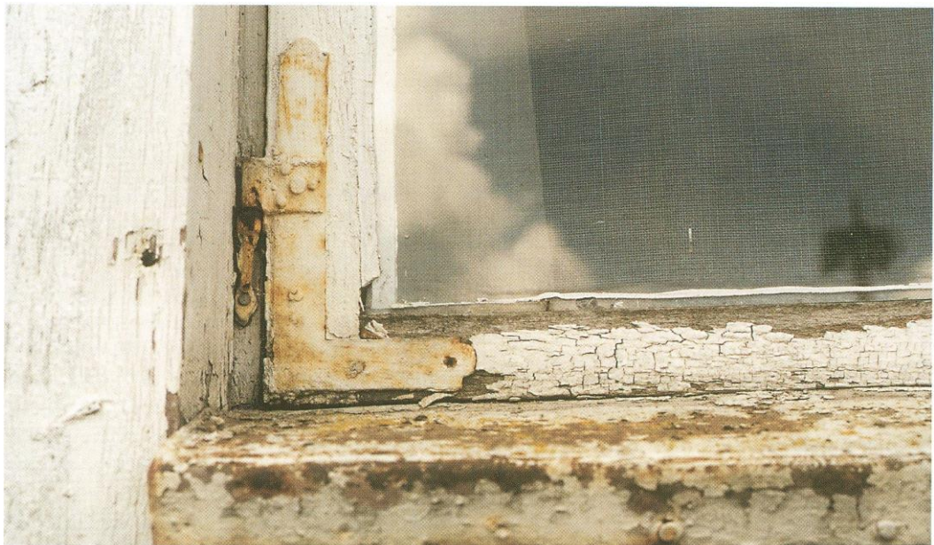
Kuvio 4. Huonokuntoisen näköinen, mutta silti korjauskelpoinen ikkuna. (Vuolle-Apiala 2008, 105)
