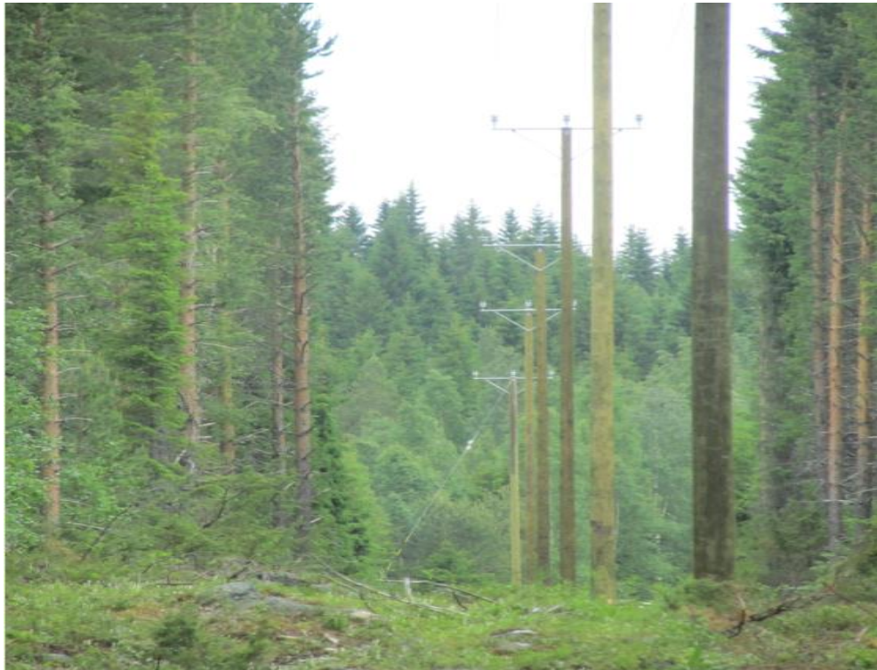
Kuva 3. Aliurakoitsijan nostamaa keskijänniteverkon pylväslinjaa. valokuva Tuomas Kamunen 2011
