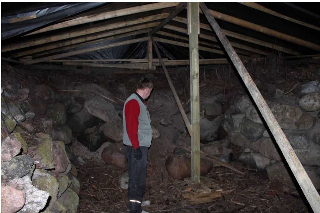
Kuva 10: Rauniokellarin osittain paikoiltaan pois pullistuneet muurit.
