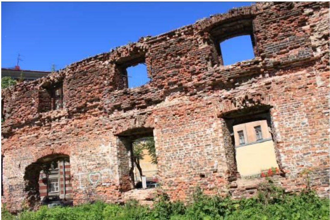
Kuva 2. Raunioituminen alkaa ylhäältä alaspäin. Kuvassa Viipurin tuomiokirkon raunion seinämuurin harjan rapautumista.
