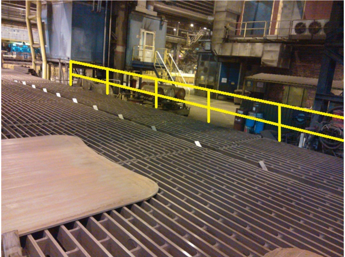
KUVA 10. Kuvassa keltaisilla viivoilla on kuvattu 1-tason puutteellinen suoja-aitaus kylmäoikaisukoneen puolelta. Pudotusta tasolta lattialle on noin yksi metri.
