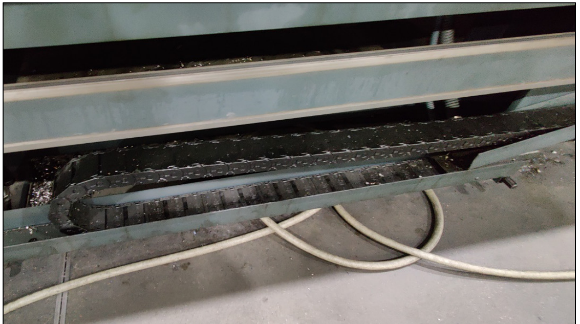
Kuva 37. CMA-porauskeskuksen tietokoneen kaapeliketju ja kouru.
