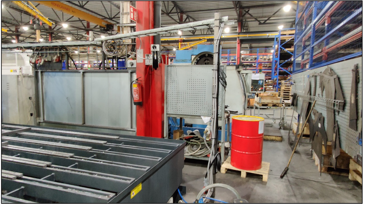
Kuva 38. Letkujen ja johtojen reititys.
