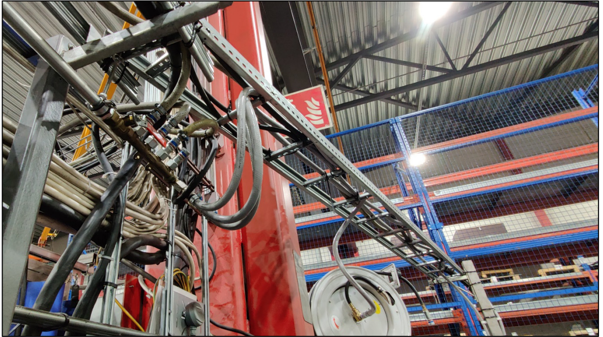
Kuva 17. CMA-porauskeskuksen kaapelitikkaat ja tolppa.
