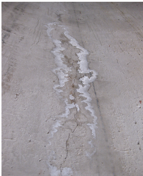
Kuva 10. Pakkasrapautumaa ja halkeilua betonirakenteessa.
