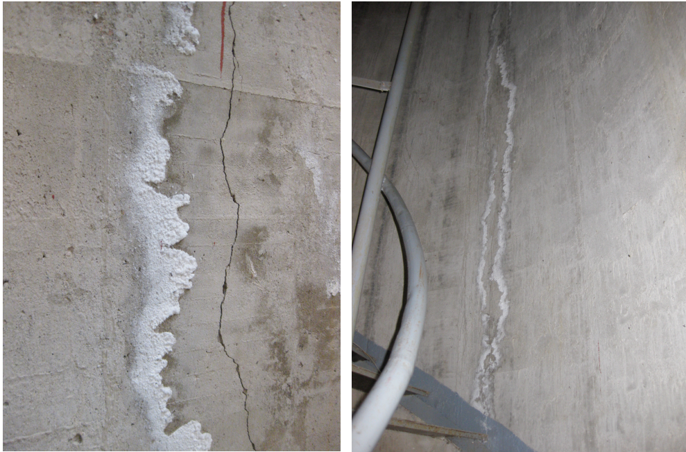
Kuvat 5a ja 5b. Pakkasrapautumisen aiheuttamaa halkeilua vesitornin jalkaosassa.
