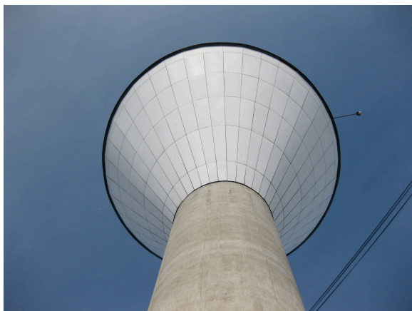
Kuva 8. Tornin yläosan mineriittilevyjä ja osittain irronnut valaisin.
