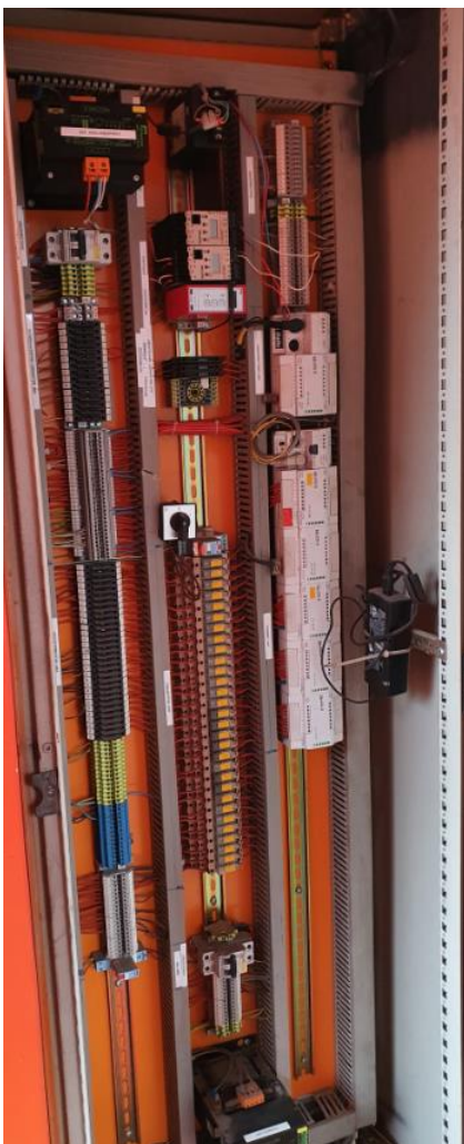
KUVA 6. PAB-koneen logiikkamoduuleille varattu sähkökaappi
