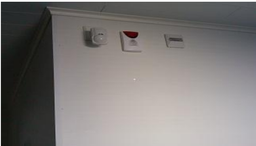
Kuva 16. Liikeilmaisin, sireeni ja tila-indikointi asennettuna kodinhoitohuoneen seinään.
