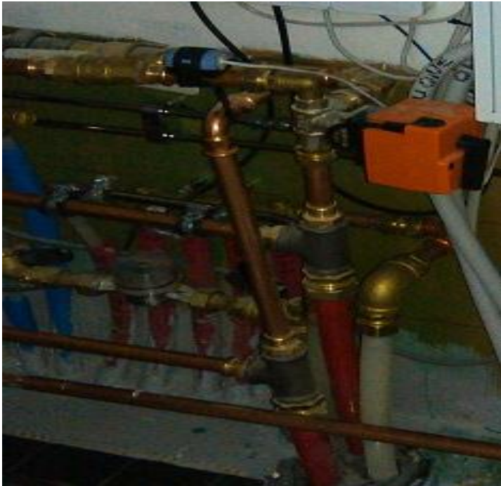
Kuva 22. Jälkishuntaus ja L2 -menovesianturi kytkettynä tekniseen tilaan.
