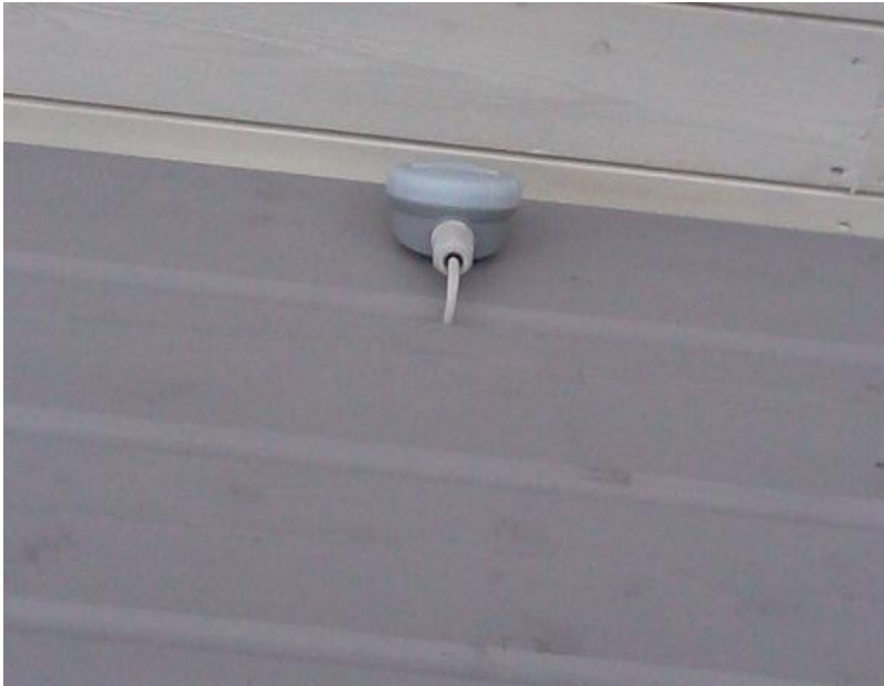
Kuva 19. Ulkolämpötila ja valoisuusanturi kytkettynä.
