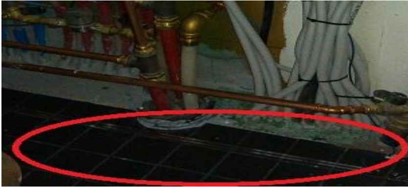
Kuva 15. Tässä näkyy vesivuotovalvonnan anturi teknisestä tilasta.
