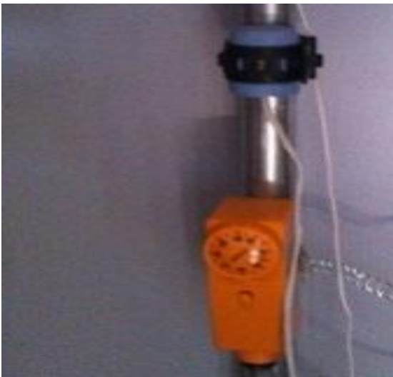
Kuva 21. L1 -menovesianturi ja ylikämpösuoja asennettuna.
