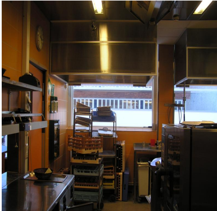
KUVA 16. Patapesukoneen huuva (Niemelä 2012)
