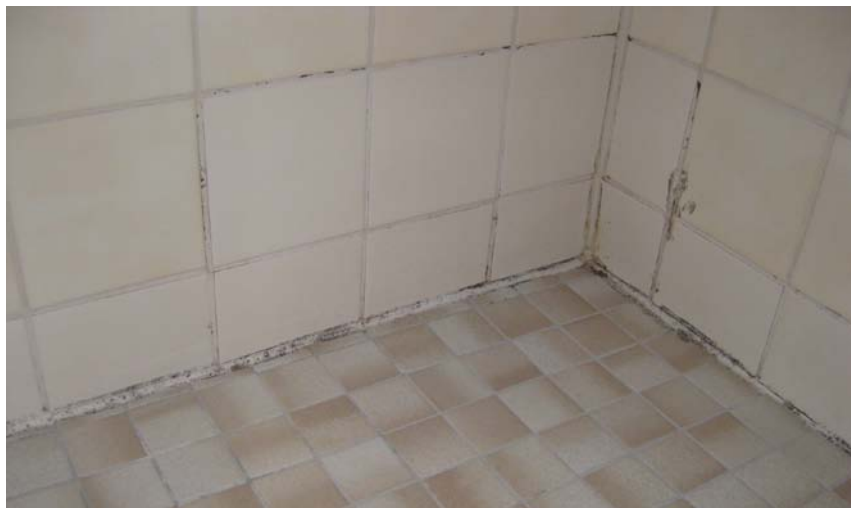
Kuva 7. Piispalan yhteisen saunaosaston pinnassa näkyviä kosteusvaurioita
