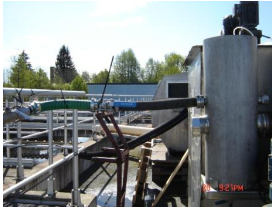
KUVA 5. Virtauksen säätö ennen laitteistoa. Valokuva M. Rytönen
