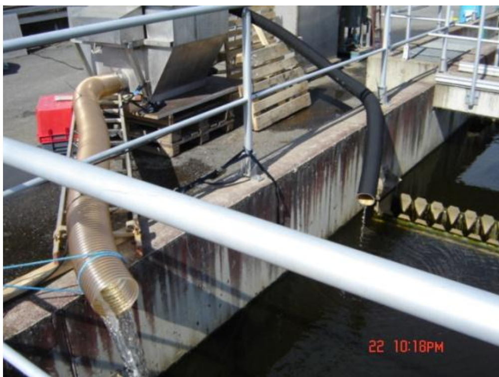
KUVA 21. Suodatetun veden (vasemmalla) ja rejektin (oikealla) poistoputket. Valokuva M. Rytönen
