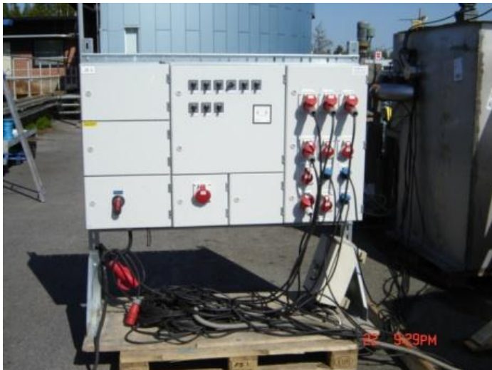
KUVA 30. Koeajolaitteiston sähkökeskus. Valokuva M. Rytönen
