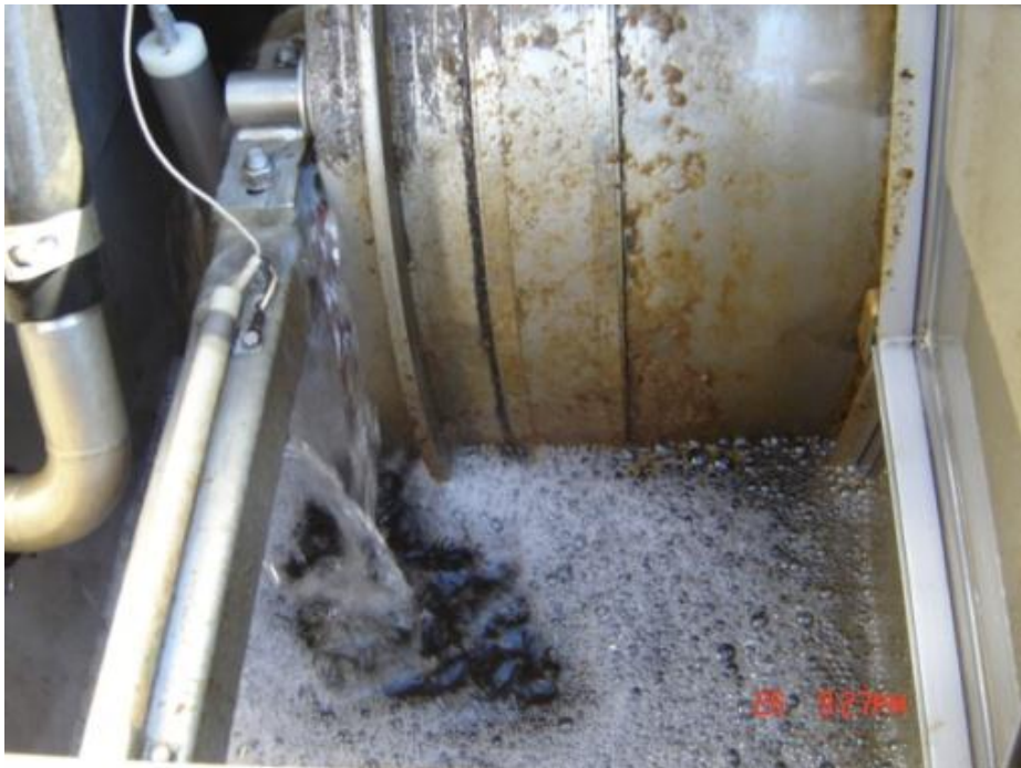
KUVA 15. Kiekkosuodattimen vesiallas ennen suodattimia. Valokuva M. Rytönen
