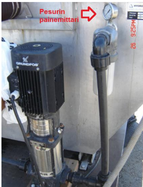
KUVA 32. Kiekkosuodattimen pesurin painemittari. Valokuva M. Rytönen
