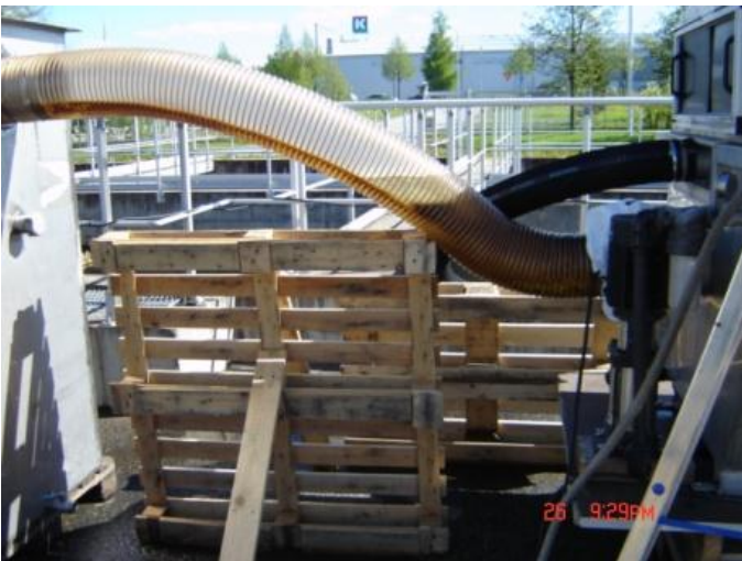
KUVA 13. Putki flokkausaltaalta kiekkosuodattimelle. Putken tukeminen oli tärkeää, jotta vesi ei päässyt padottumaan, eikä putki irtoamaan veden painosta. Valokuva M. Rytönen
