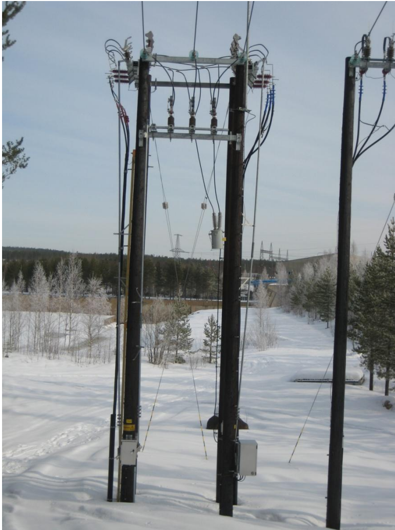
Kuva 7. Kaukokäyttöerotinasema ja omakäyttömuuntaja /13/
