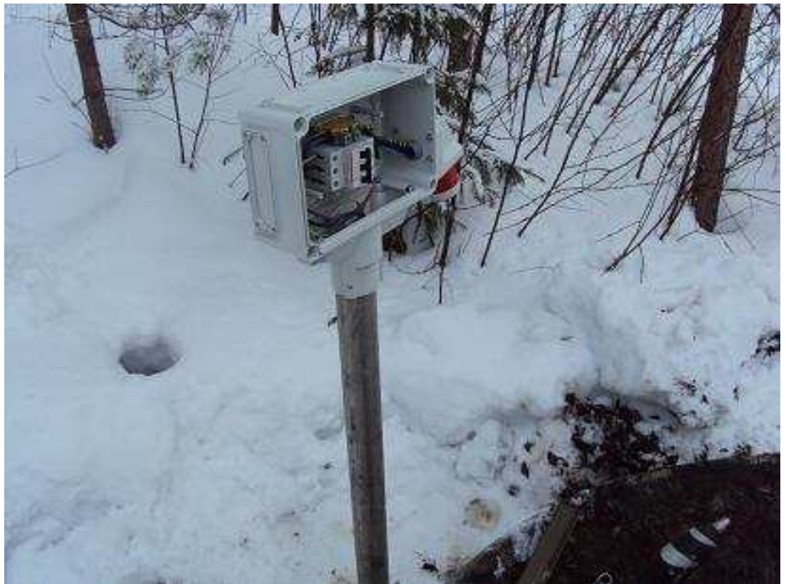
Kuva 10. Kojevastake asennettuna Savikon paineenkorotuspumppaamolla.
