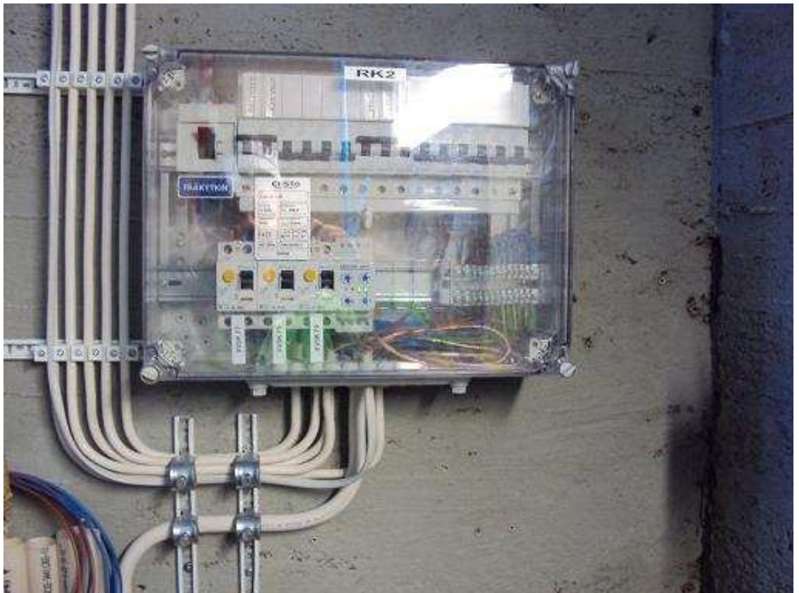
Kuva 7. Vaihevahti asennettuna ryhmäkeskukseen
