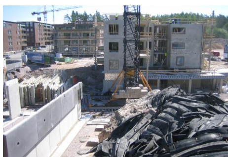
Kuva 17. B-talon elementtiasennus käynnissä kolmannessa kerroksessa ja työmaatietä ei ollut edes aloitettu tekemään kuvassa vasemmalla näkyvän A-talon luokse.
