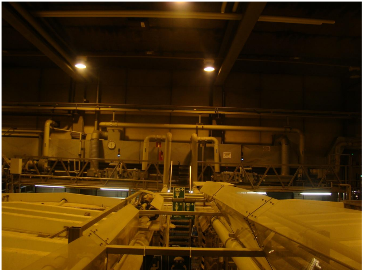
Kuvio 1. Peittausaltaat FV-1 ja FV-2 sekä ilmanvaihtoputkisto.
