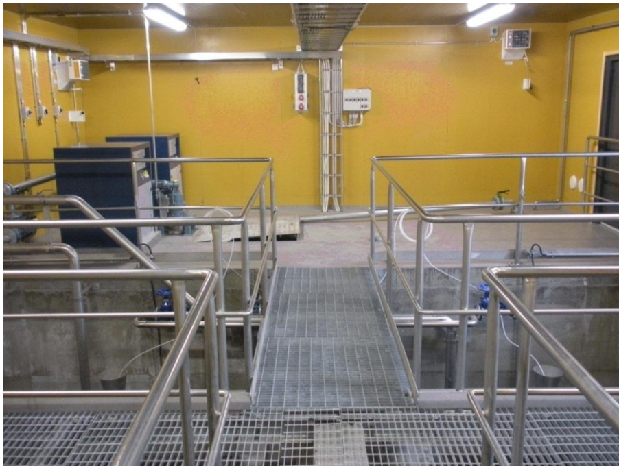
Kuva 3 Sannaisten puhdistamo sisäpuolelta. Kuva Aleksi Rajala
