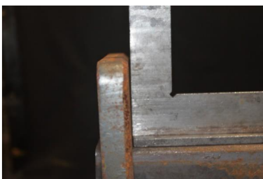
Kuva 13 Kohtisuoruuspoikkeama pylvään kiinnityslevyssä.
