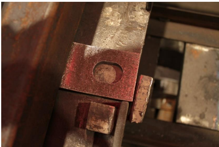
Kuva 12 Ylimääräinen siltajohteen korvakkeen vaste.
