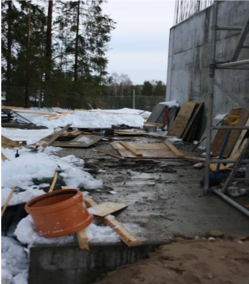
KUVA 6. Työmaan järjestys on laiminlyöty. Kuva Marko Niiranen 2012
