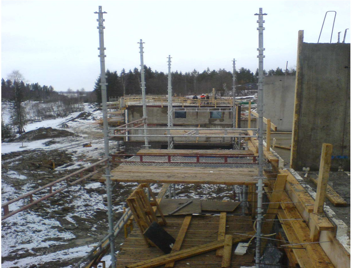
KUVA 2. Puutteellinen putoamissuojaus. Kuva Marko Niiranen 2012
