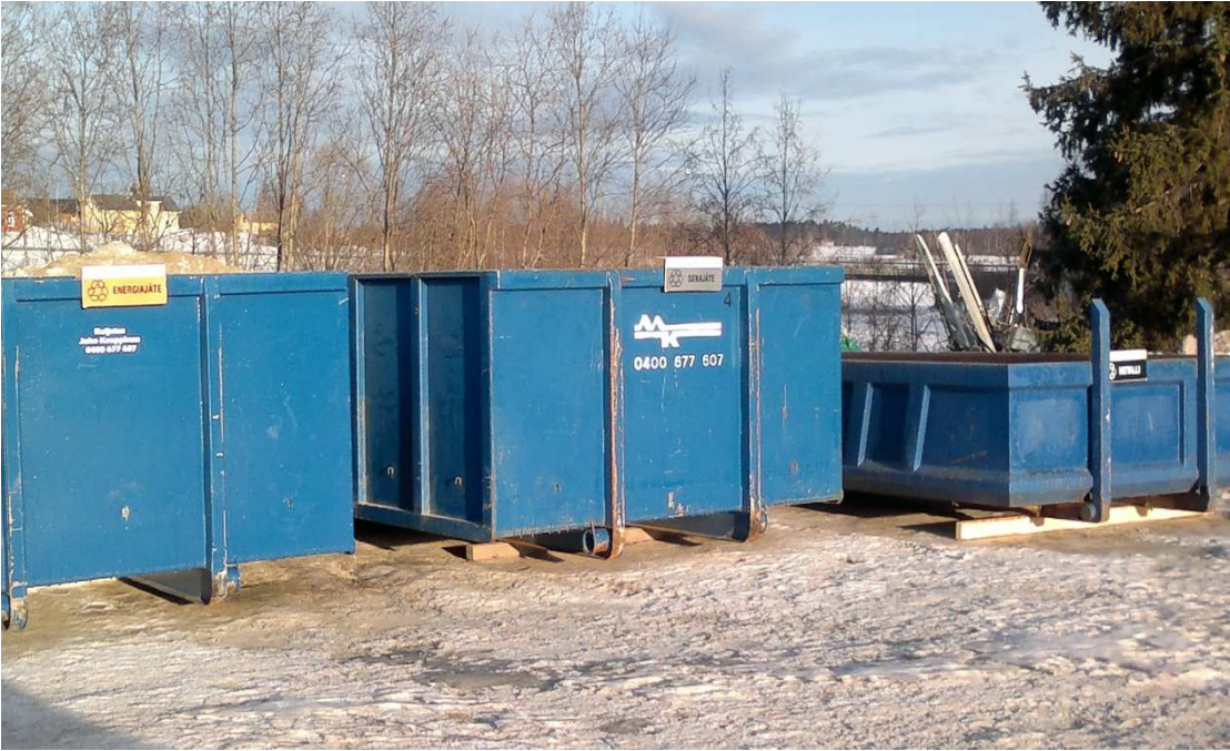
Kuva 7. Jäteastiat, joihin mahtuu vielä jätettä. Työkohteessa on huomioitu myös jätteen lajittelu. Kuva Marko Niiranen 2012
