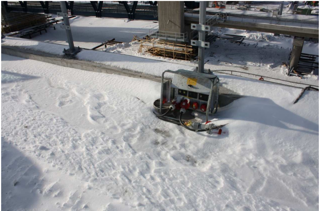
KUVA 1. 16 A sähkökaappi joka on ehjä ja hyväkuntoinen, mutta sijoitettu väärin. Kuva Marko Niiranen 2012
