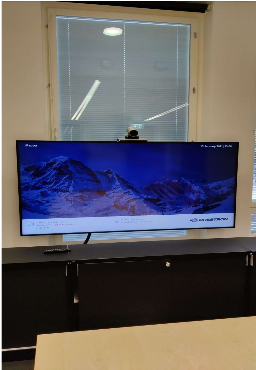
Kuva 3. Neuvotteluhuone Ulapan laitteisto. AM-200 on kiinnitetty television taakse
