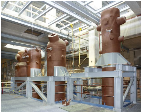
Kuva 2 Korkeapaine-esilämmitin (Sahala Works Oy)
