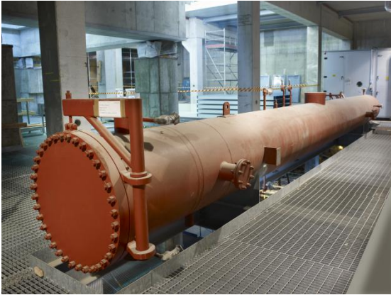
Kuva 3 Matalapaine-esilämmitin (Sahala Works Oy)
