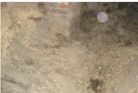
Kuva 12 Kuvan vasemmassa reunassa näkyy lahonneita ap:n rakenteita, jotka vaikuttivat olevan halaspuolikkaita vierekkäin. Kuva on keittiöstä
