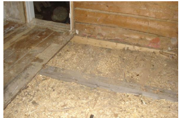
Kuva 11 Lattialankkujen alta paljastui sahanpurua, kuva on keittiöstä
