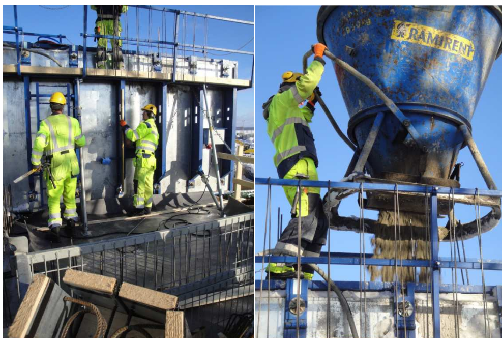
KUVA 10. Muotin pystysuoruuden tarkistaminen ja seinän valaminen nostoastialla. Kaiteella näkyvät myös seinän yläosaan kiinnitettävät tartuntateräkset, jotka painetaan betoniin valun jälkeen. Kuva Maiju Leskinen.
