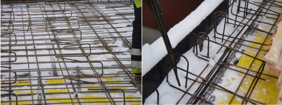
KUVA 15. Holviraudoituksen tukipukit, joiden varaan yläpinnan raudoitus asennetaan ja holvin reuna-alueen raudoitus. Kuva Maiju Leskinen.
