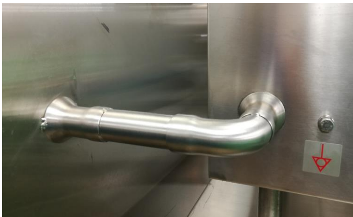
Kuva 3. Sähkökaapelin rst suojaputki (Meyer Turku Oy 2017)
