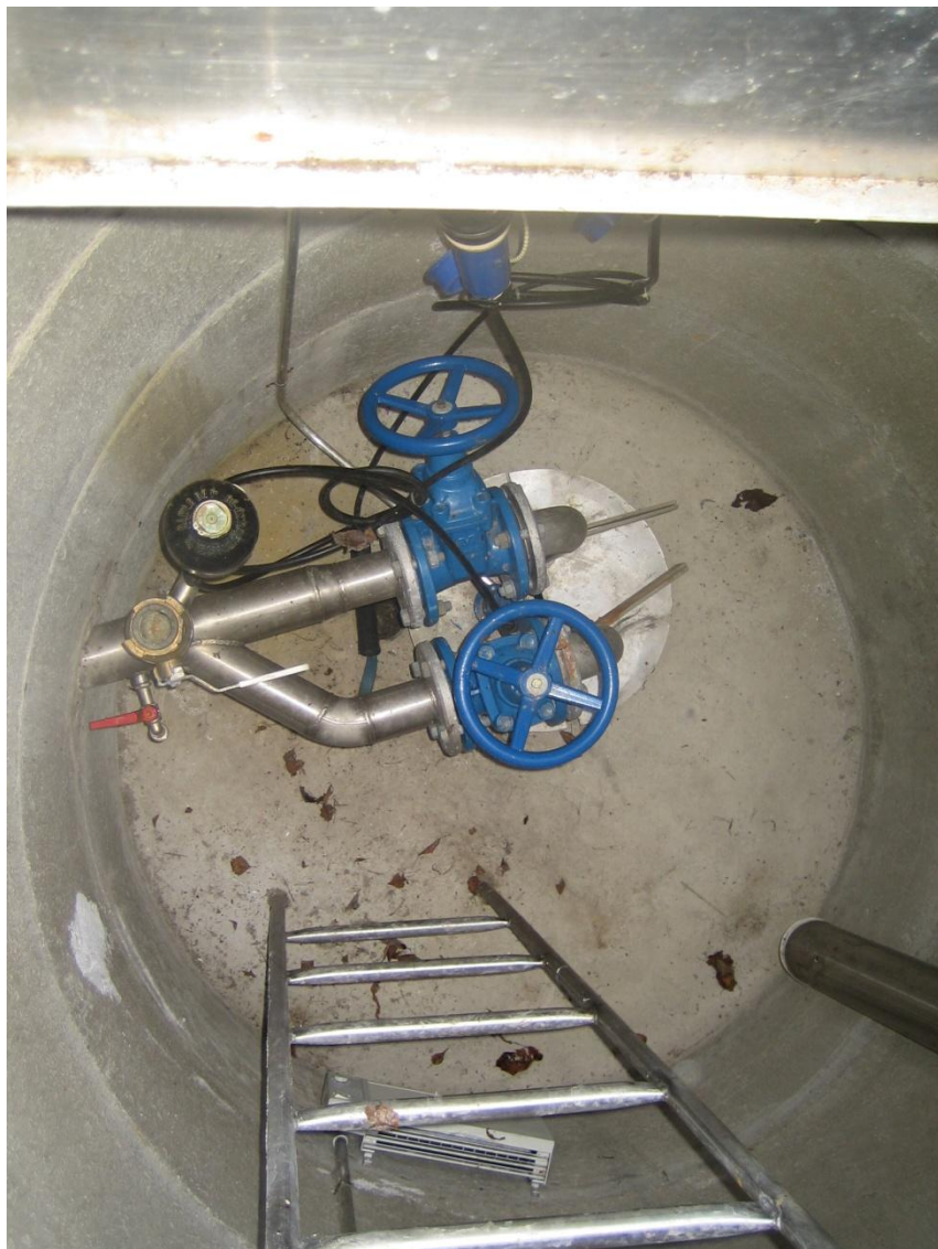
Kuva 2. Hyvärilän vedenottamon siiviläputkikaivo.
