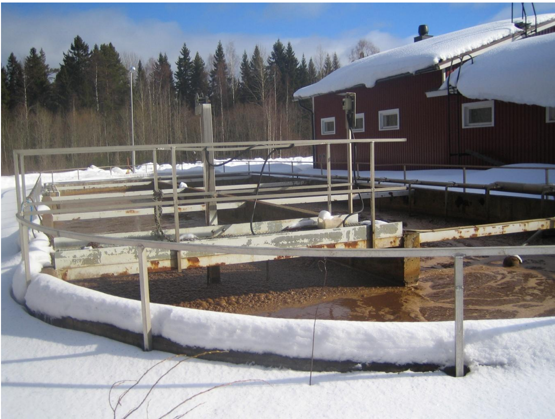
Kuva 7. Ilmastusaltaat Pahkasalon jätevedenpuhdistamon pihalla. Valokuva Linda Luostarinen 2012.
