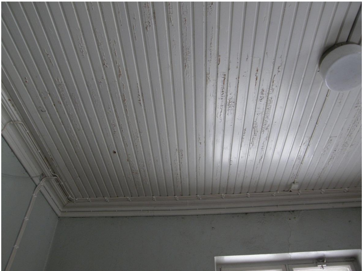
Kuvio 30. Alakerran kattopaneelien maalin kupruilu.
