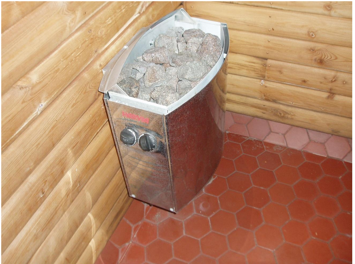
Kuva 17. Kiuasta ei ole suojattu lainkaan.
