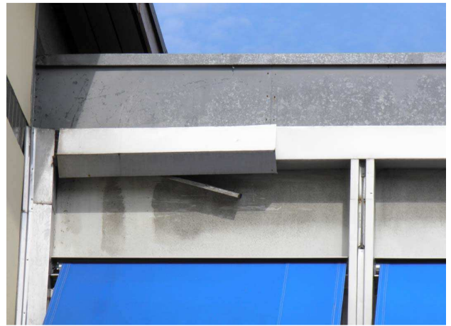
Bild 21 F4 Övrebjälklagsutrustning, Ränna Stuprännan på fasaden mot torggatan är söndrig, den bör bytas ut.
