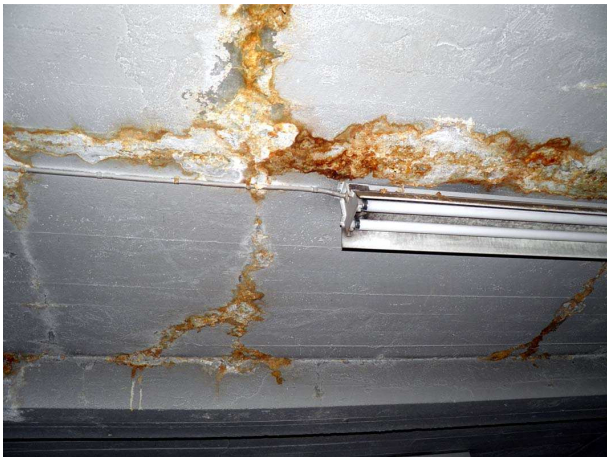
Bild 30 F6 Utrymmens ytstrukturer, Tak bilhall Här är insidan av bilhallstaket. Man ser tydligt att taket är fuktskadat. Här är ett av ställena jag rekommenderar hållfasthets prov tas på)
