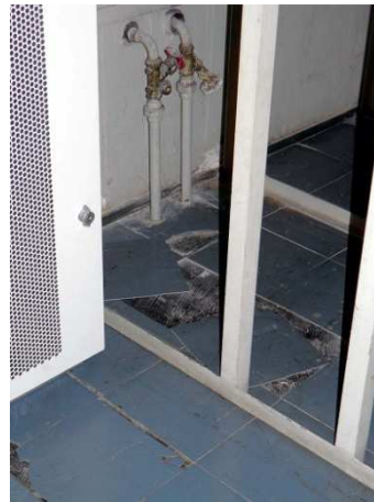
Bild 33 F6 Utrymmens ytstrukturer, Golv källare Golvplattorna i källaren har lossnat på en del ställen, limmet innehåller sannolikt asbest.
