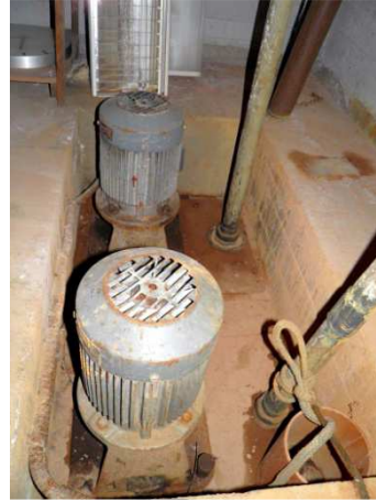
Bild 38 G2 Vatten och avlopp, pumprum Endast en av dessa pumpar fungerar, en reservpump har sänkts ner i brunnen och fungerar nu som huvudpump.
