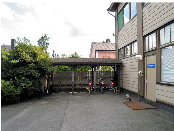
Bild 2 D7 Beläggningar, Asfalt Asfaltlocket ovanpå parkeringshallen bör bytas ut, då det befintliga släpper in vatten.
