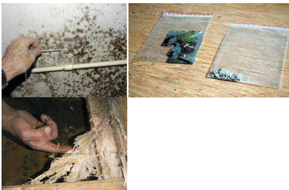
Bild 4,5,6 Bilder från provtagningar på mögel, asbest och hussvamp.
