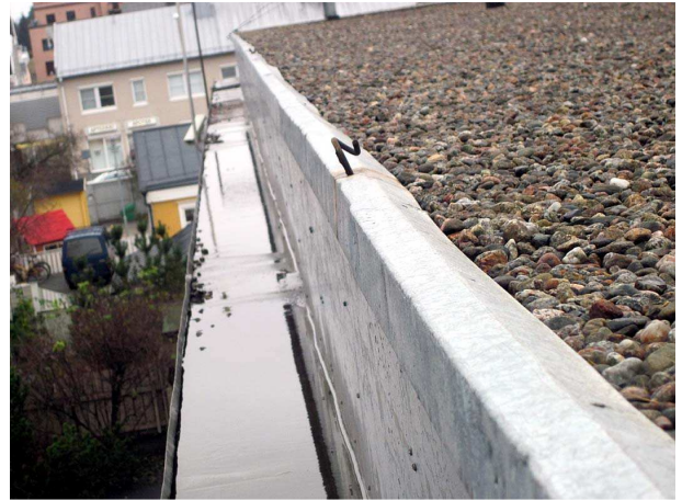
Bild 20 F4 Övrebjälklagskonstruktioner, Tak Takkanten är felkonstruerad och vatten läcker in i kontoren på andra våningen. Bör åtgärdas.
