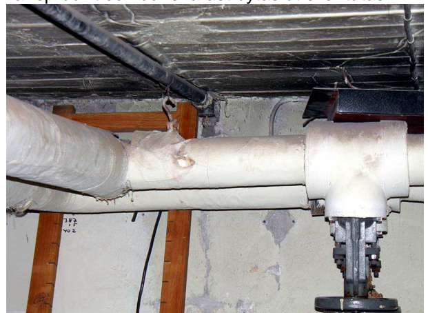
Bild 40 G2 Vatten och avlopp, källare. I källaren finns asbestbeklädda rör som bör saneras.
