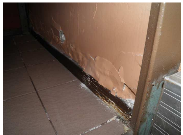
Bild 28 F6 Utrymmens ytstrukturer, Golv och vägg källare Både golv och väggar i skolningsutrymmet är fuktskadade.
