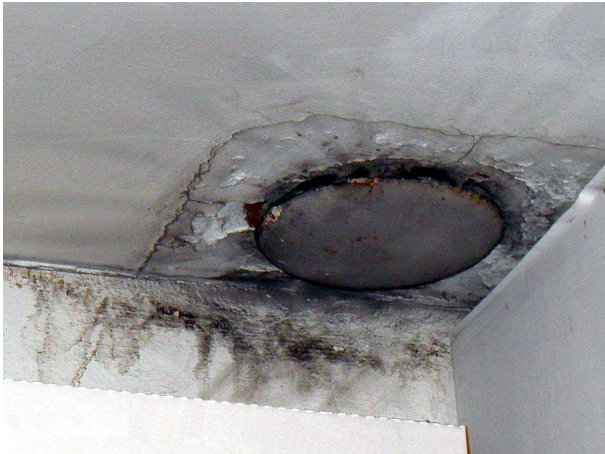
Bild 41 G3 Ventilations system, Gamla ventilationen Den gamla ventilationen är mycket smutsig och bör rengöras.
