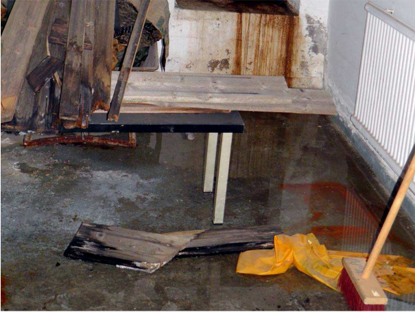
Bild 35 F6 Utrymmens ytstrukturer, Golv källare Under vinterhalvåret samlas vatten i källaren.
