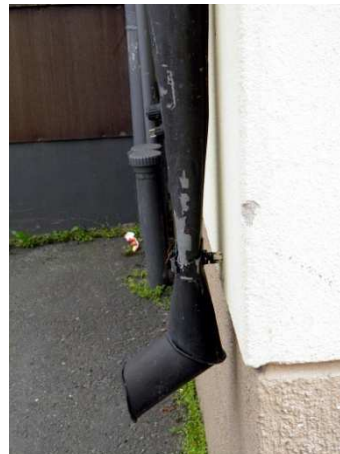
Bild 22 F4 Övrebjälklagsutrustning, Stuprör En del av stuprören är söndriga och bör bytas ut.
