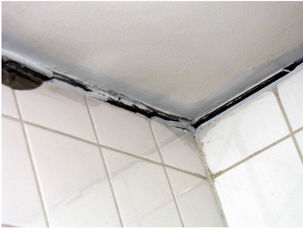
Bild 29 F6 Utrymmens ytstrukturer, Vägg omklädningsrum Kaklet har spruckit löst i källarens omklädningsrum.
