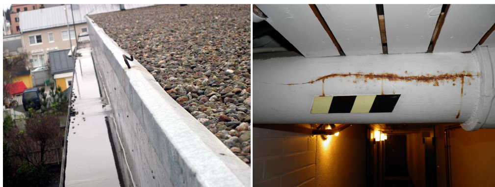
Bild 26 Takkant som släpper in vatten.
