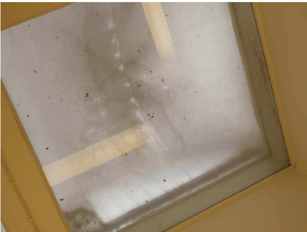
Bild 24 F4 Övrebjälklagsutrustning, Takfönster Takfönsterkupolerna släpper in fukt. Bör åtgärdas.
