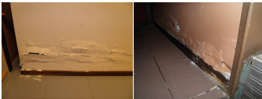
Bild 14,15 Fuktskador på väggar i källare
