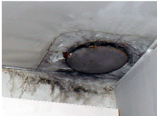
Bild 12, Gamla ventilationen var mycket smutsig, materialprover togs från taket kring ventilationen.
