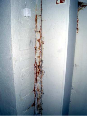
Bild 11 F1 Grundkonstruktioner, Källarväggar Väggarna har förstörts av att vatten har sluppit in i väggen när vattenavrinningen inte fungerar. Se bild 6.
