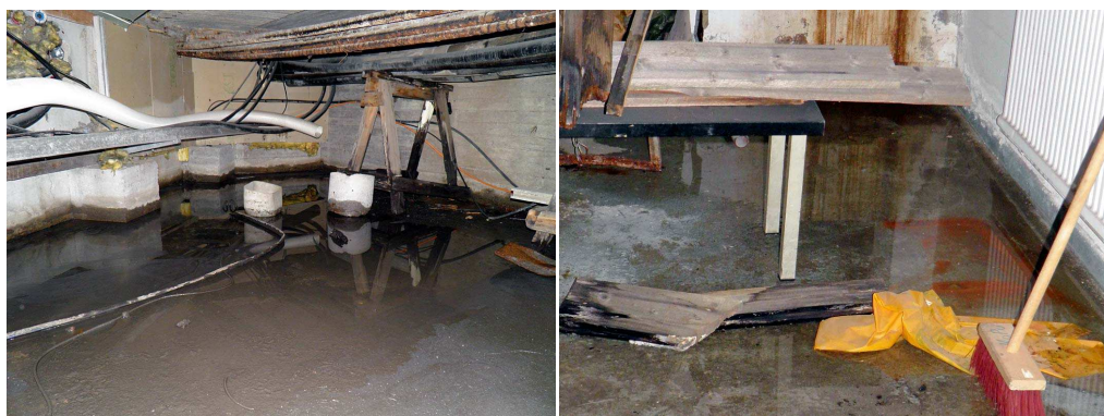
Bild 28 I kabelkällaren används felaktiga kabelhyllor vilket medför en stor fara då kabelkällaren ofta är vattenfylld.
