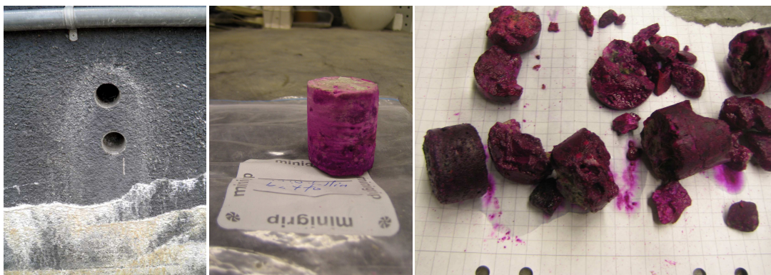
Bild 21,22,23 Stödmur efter att borrkärnor tagits samt karbonatiseringsprov.
