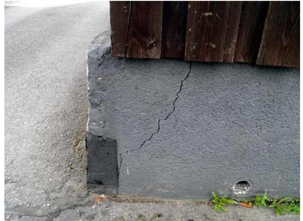
Bild 8 F1 Grundkonstruktioner, Sockel Sockeln har på flera ställen spruckit.
