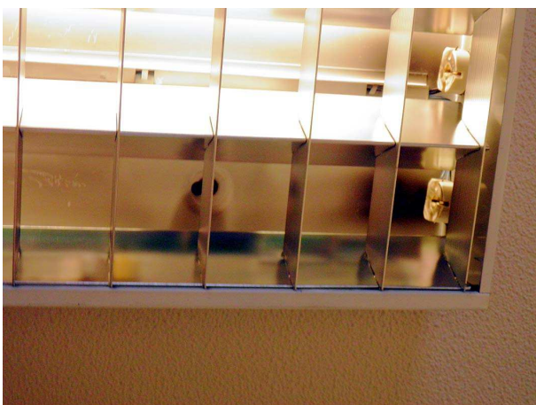
Bild 43 H5 Belysning Lamparmaturerna på andra våningen är söndriga och bör bytas.
