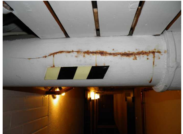
Bild 39 G2 Vatten och avlopp, regnvattenrör Ett av regnvattenrören som går igenom källaren har spruckit och bör snarast bytas ut eller tätas.
