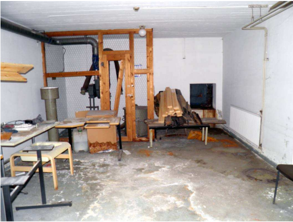
Bild 12 F2 Byggnadens stomme, Befolkningsskydd Ytorna i befolkningsskyddet är fuktskadade. Åtgärdas i samband med fuktсанering.
