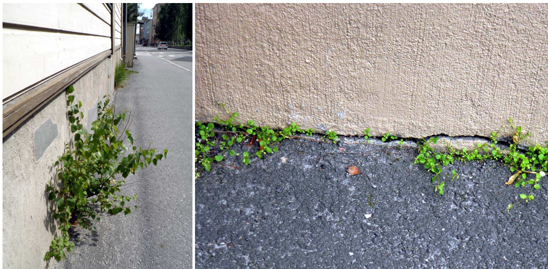
Bild 16,17, Växtlighet och sprickor vid sockel.
