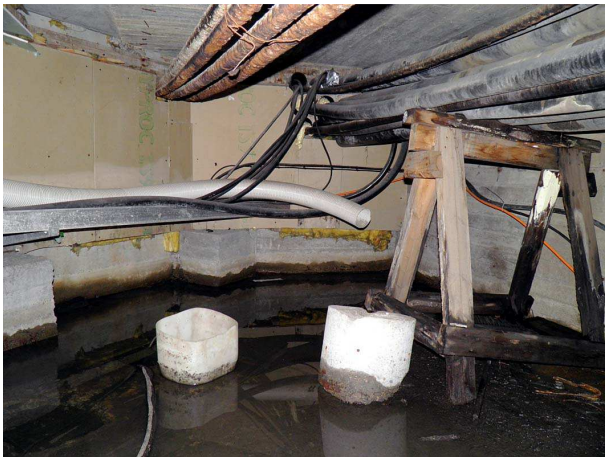
Bild 42 H3 Kabelvägar, kabelhyllor källare I kabelkällaren finns många kablar som inte är placerade på ändamålsenliga hyllor. Bör åtgärdas.
