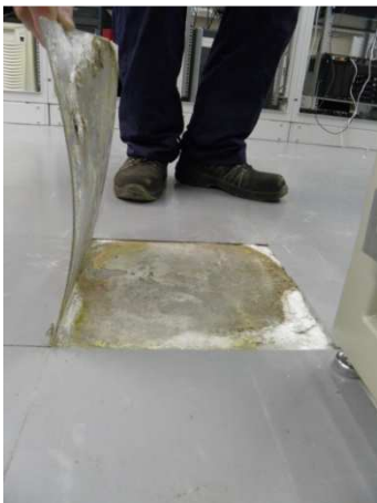
Bild 31 F6 Utrymmens ytstrukturer, Golv serverhotell Golvplattorna har lossnat pga. fukt.
