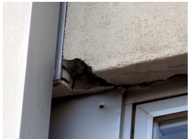
Bild 16 F3 Fasad, Element Från elementen på innergården har bitar lossnat kring fönstrena.
