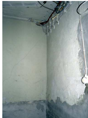
Bild 27 F6 Utrymmens ytstrukturer, Väggar källare Man ser tydligt var vatten nivån har varit i väggarna
