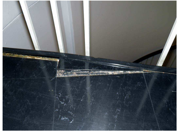
Bild 32 F6 Utrymmens ytstrukturer, Golv vån 2 En del golvplattor har lossnat i trappuppgången.
