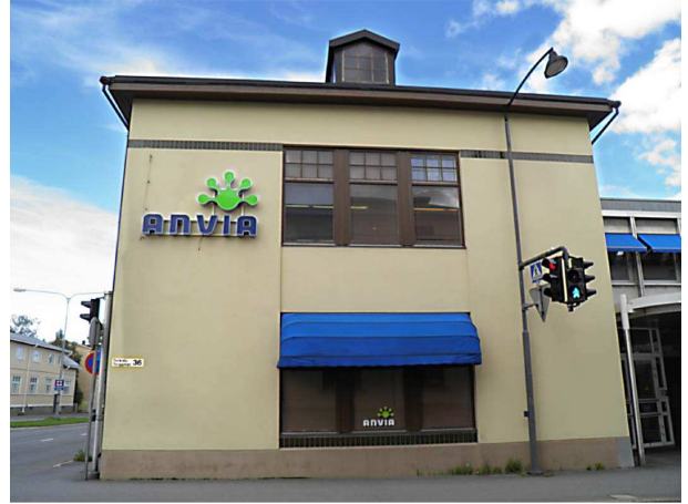
Bild 14 F3 Fasad Fasaden mot Torggatan är i gott skick.
