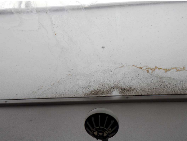
Bild 23 F4 Övrebjälklagsutrustning, Takfönster Takfönsterkupolerna släpper in fukt. Bör åtgärdas.
