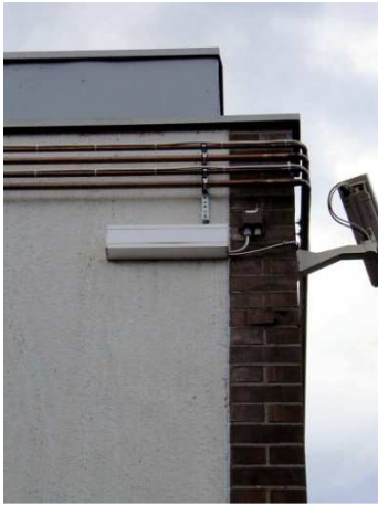
Bild 17 F3 Fasad, Tegel En del av teglen har gått sönder. Bör åtgärdas så att frosten inte spränger sönder fasaden mera.
