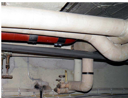
Bild 29 Asbest beklädda rör i källaren.
