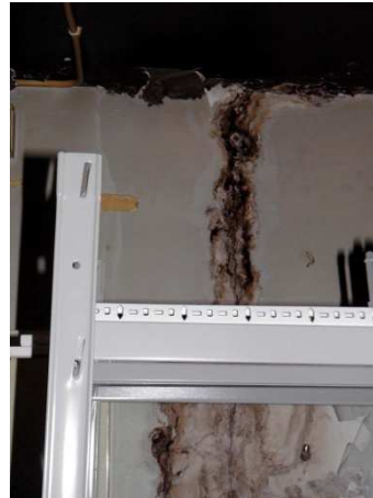
Bild 26 F6 Utrymmens ytstrukturer, Väggar källare Så gott som alla väggar i källaren är fuktskadade.
