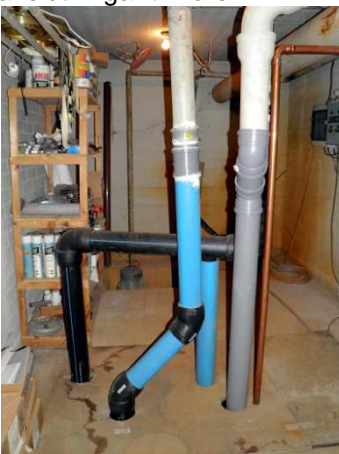
Bild 37 G2 Vatten och avlopp, Avloppsrör Rören är inte är inte korrekt ihopfogade, man bör göra ändamålsenliga tryckrörs fogar mellan avloppsrören.
