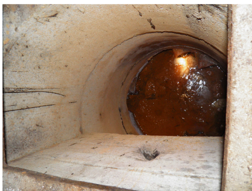
Bild 18, En av brunnarna på fastigheten, alla brunnar var slamfyllda.
