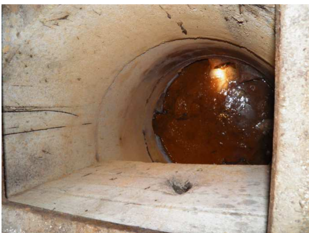
Bild 7 E4 Brunnar Alla brunnar är fyllda med slam och bör pumpas ur.
