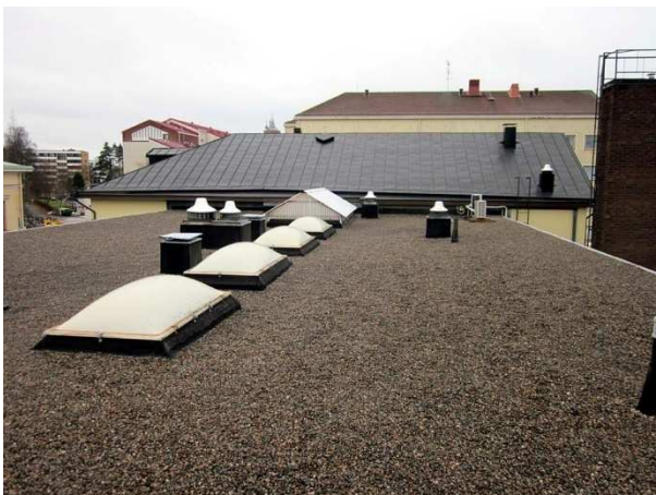
Bild 19 F4 Övrebjälklagskonstruktioner, Tak Takfönsterkupolerna är otäta, de bör bytas ut eller tätas.
