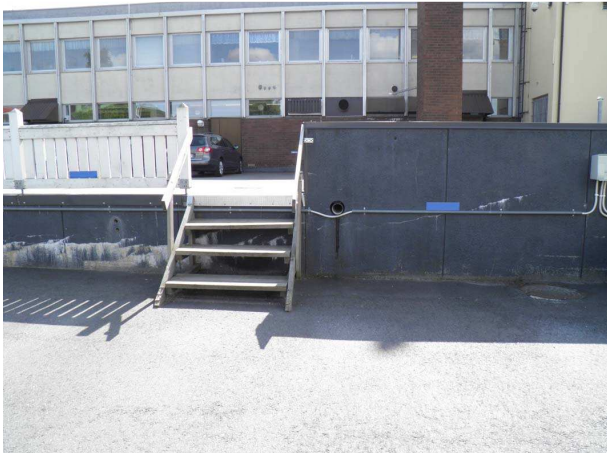
Bild 5 D9 Utvändiga konstruktioner, Stödmur Stödmuren är fuktskadad, betongprov har tagits av muren, men det gick ej att analysera.
