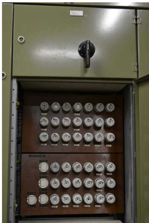
Kuvio 7. Tulppavarokelähtöjä ABB Service Oulun pääkeskuksessa
