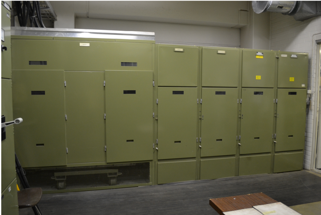
Kuvio 10. ABB Service Oulun sähkötilassa oleva kj-kojeisto
