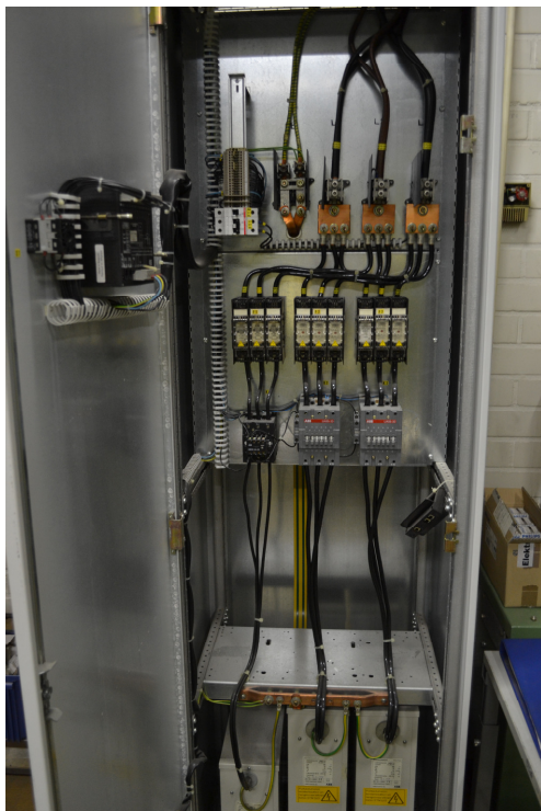
Kuvio 11. ABB Service Oulun kompensointilaitteisto
