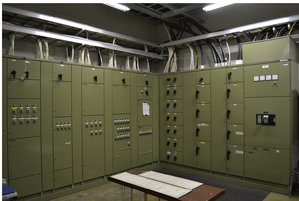
Kuvio 6. ABB Service Oulun sähköpääkeskus
