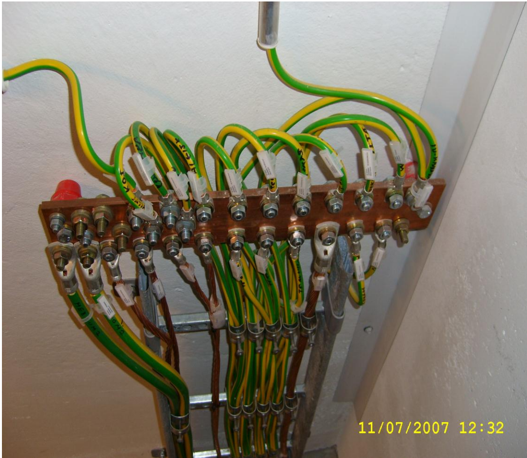
Kuva 2. Muuntamon maadoituskisko ja maadoitusjohtimet
