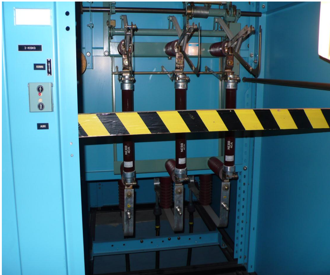
Kuva 7. Varokeuormanerotinkkenno ja suurjännitesulakkeet paikoillaan
