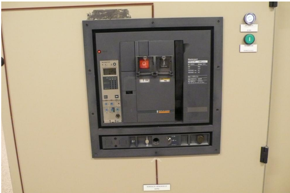
Kuva 3. Pääkatkaisija, jossa myös johdonsuojaterminaali
