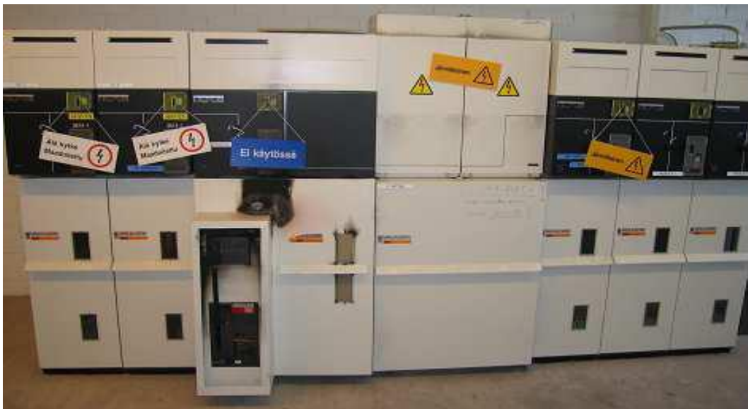
Kuva 11. Varoituskylttien asettelu muuntamossa
