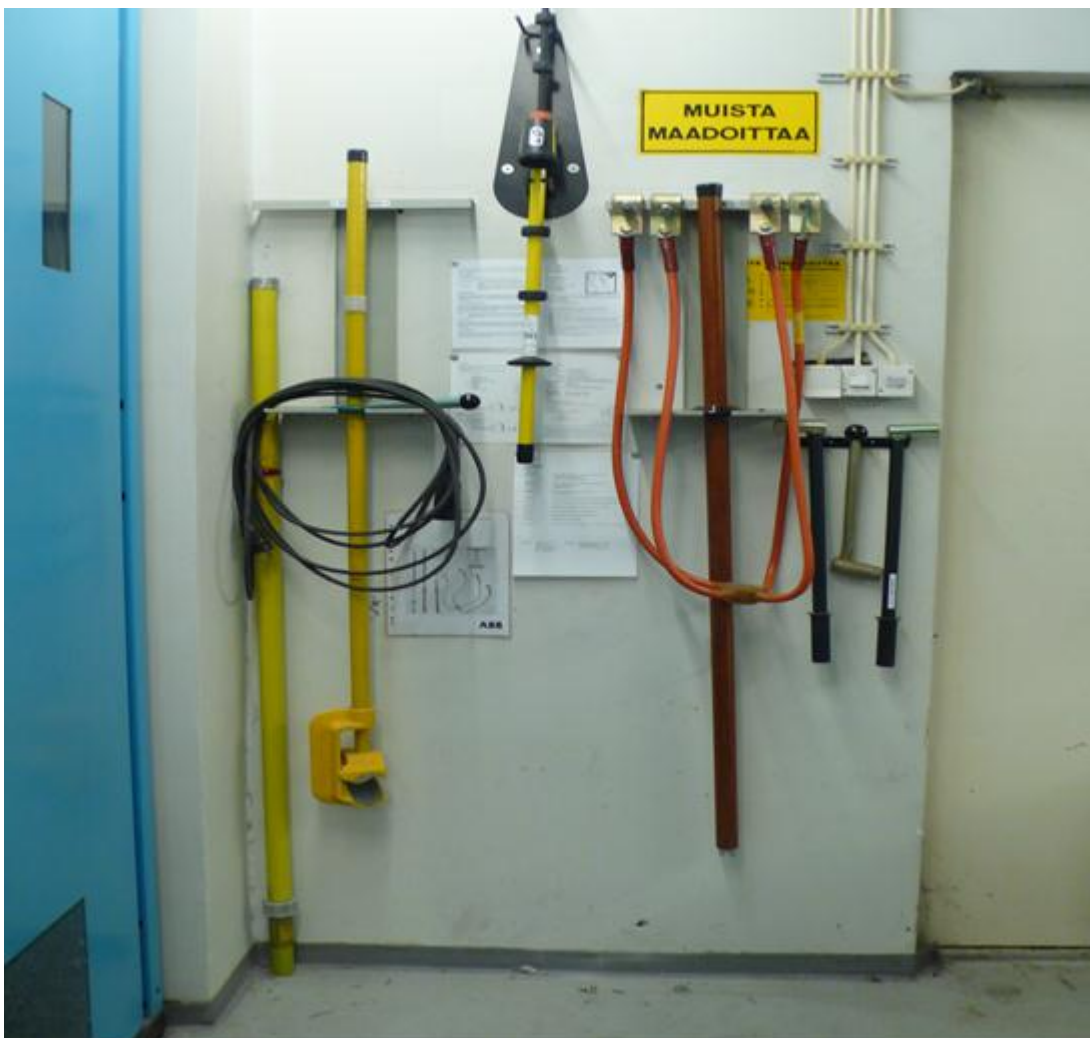
Kuva 21. Rakennukseen sijoitetun muuntamon hoitotarvikkeita
