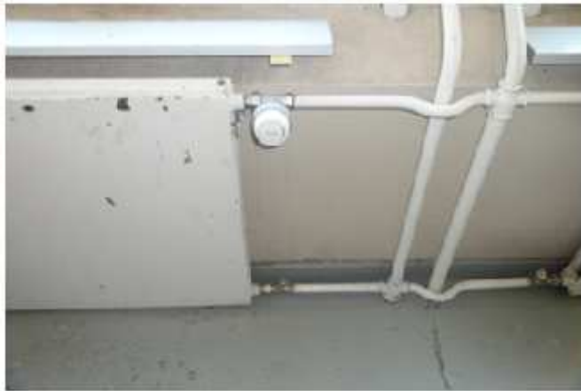
Kuva 19. Kuvataideluokassa olevan lämpöpatteri
