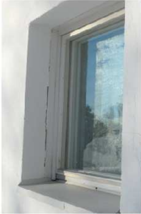
Kuva 1. Halkeama ikkunan ja seinän liittymäkohdassa
