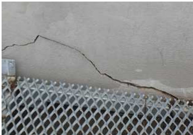
Kuva 1. Perusmuurissa oleva halkeama
