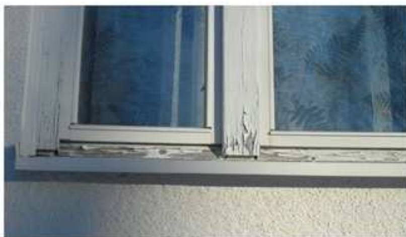
Kuva 2. Huonokuntoiset ikkunoiden puuosat
