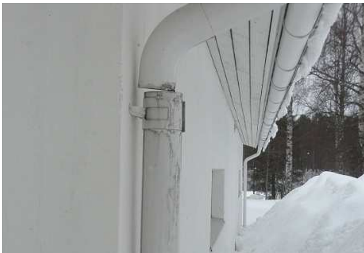
Kuva 3. Syöksytorven liitos on irronnut
