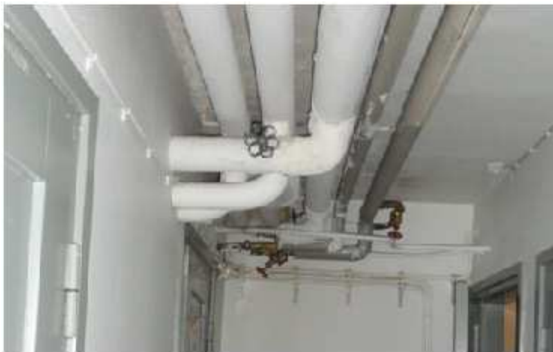
Kuva 8. Lämmitys ja käyttövesiputkistoa
