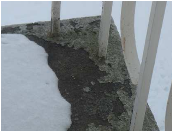
Kuva 4. Parvekelaatan pintavauriot ja kaiteiden kiinnityksen ruostuminen
