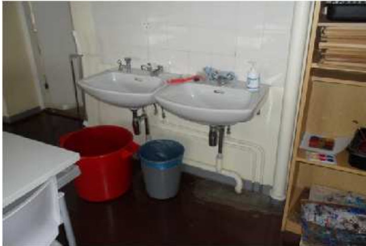
Kuva 14. Luokkatilassa olevia vesikalusteita
