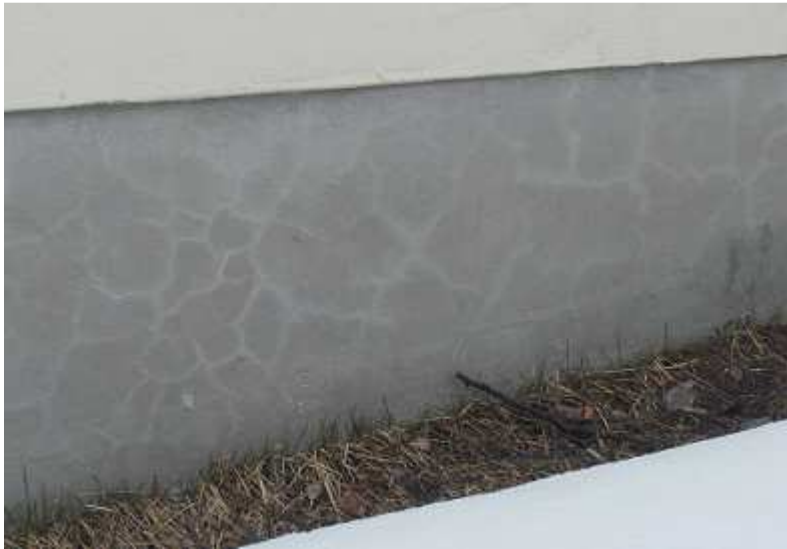
Kuva 2. Perusmuurissa olevia pieniä halkeamia
