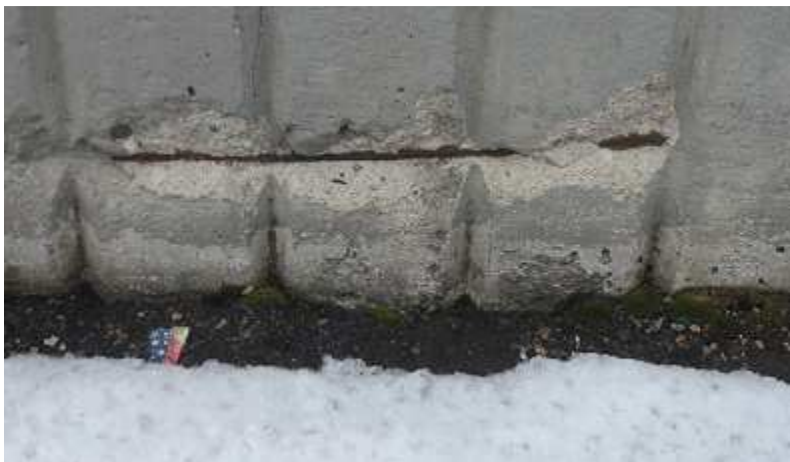
Kuva 1. Perusmuurissa oleva vauriokohta
