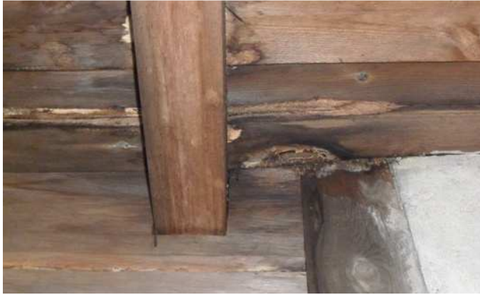
Kuva 2. Hormin, väliseinän ja sisäkaton risteämä
