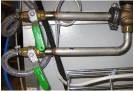
KUVA 9. Kuuma- ja kylmävesiventtiilit auki: V26 ja V27
