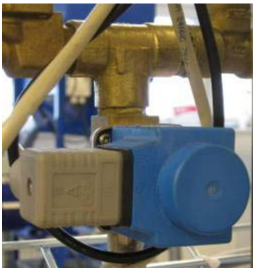
KUVA 18. Kylmän pesueden poistiventtiili V25
