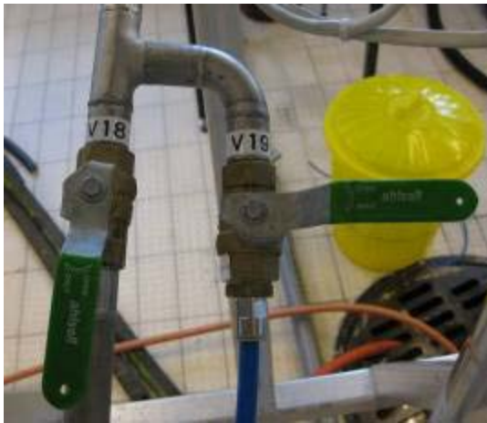
KUVA 14. Venttiilit V18 ja V19
