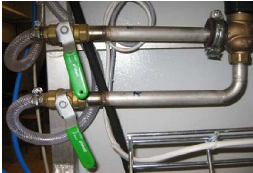
KUVA 3. Kylmä- ja kuumahana (laitteisto)
