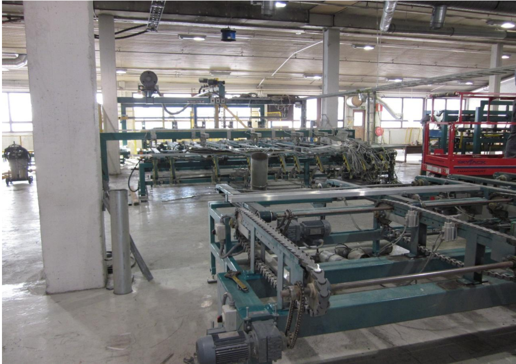
Kuva 12. Linjalaitteet sijoitettuna uusilla paikoilla.
