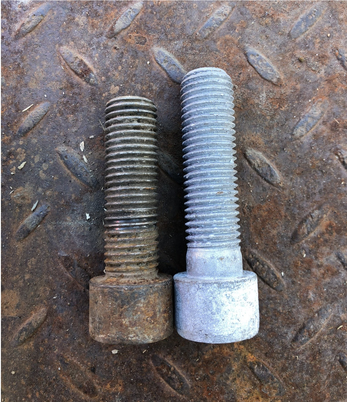
KUVA 28. Kansiruuvien pituuksissa oli suurta hajontaa sekä kierteissä huonokuntoisuutta
