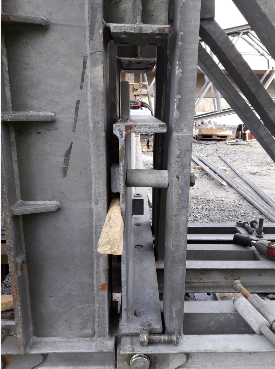
KUVA 27. Nivelen kohdalla sidepulttiyhdistelmän kiinnittäminen oli ongelmallista
