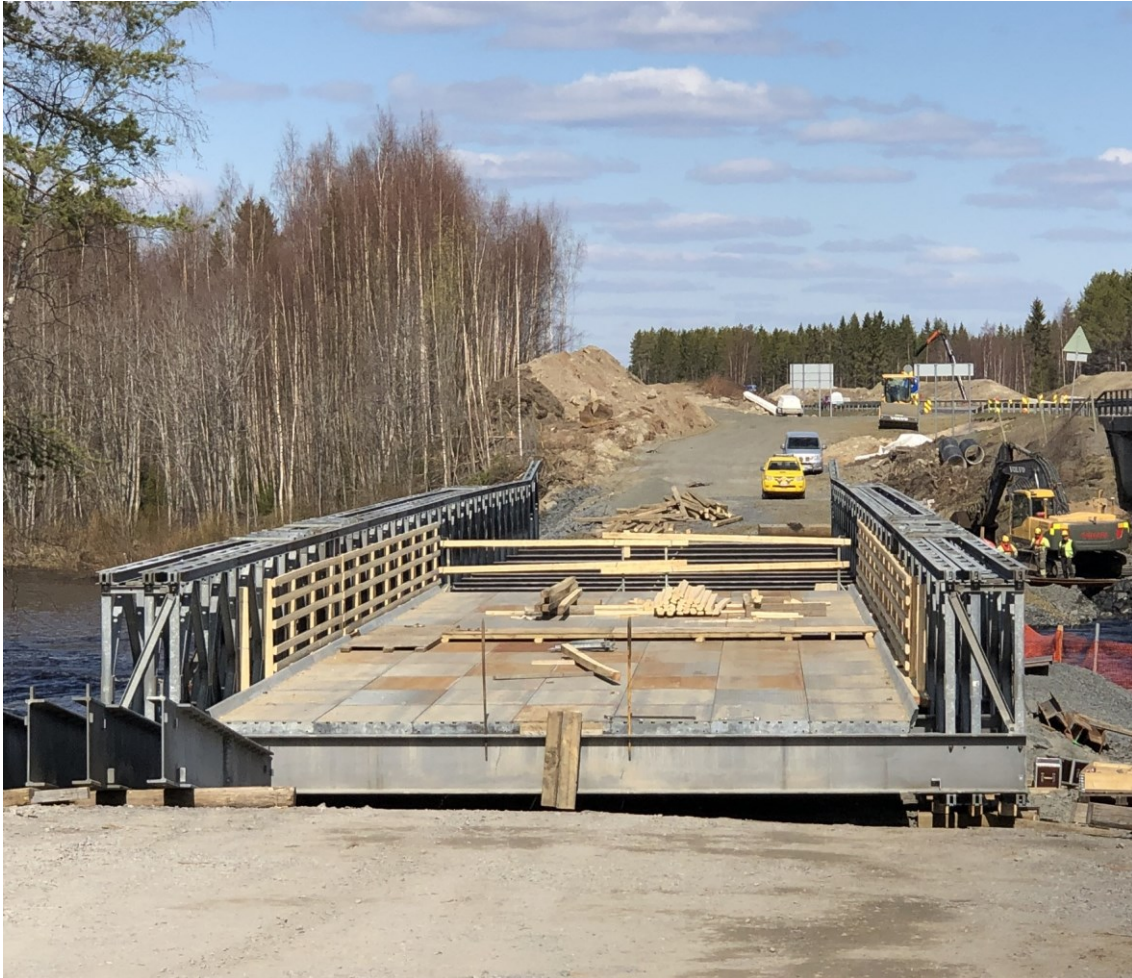
KUVA 29. Holvireunakaiteiden avulla estettiin pääsy alueelle, josta puuttuivat kansielementit
