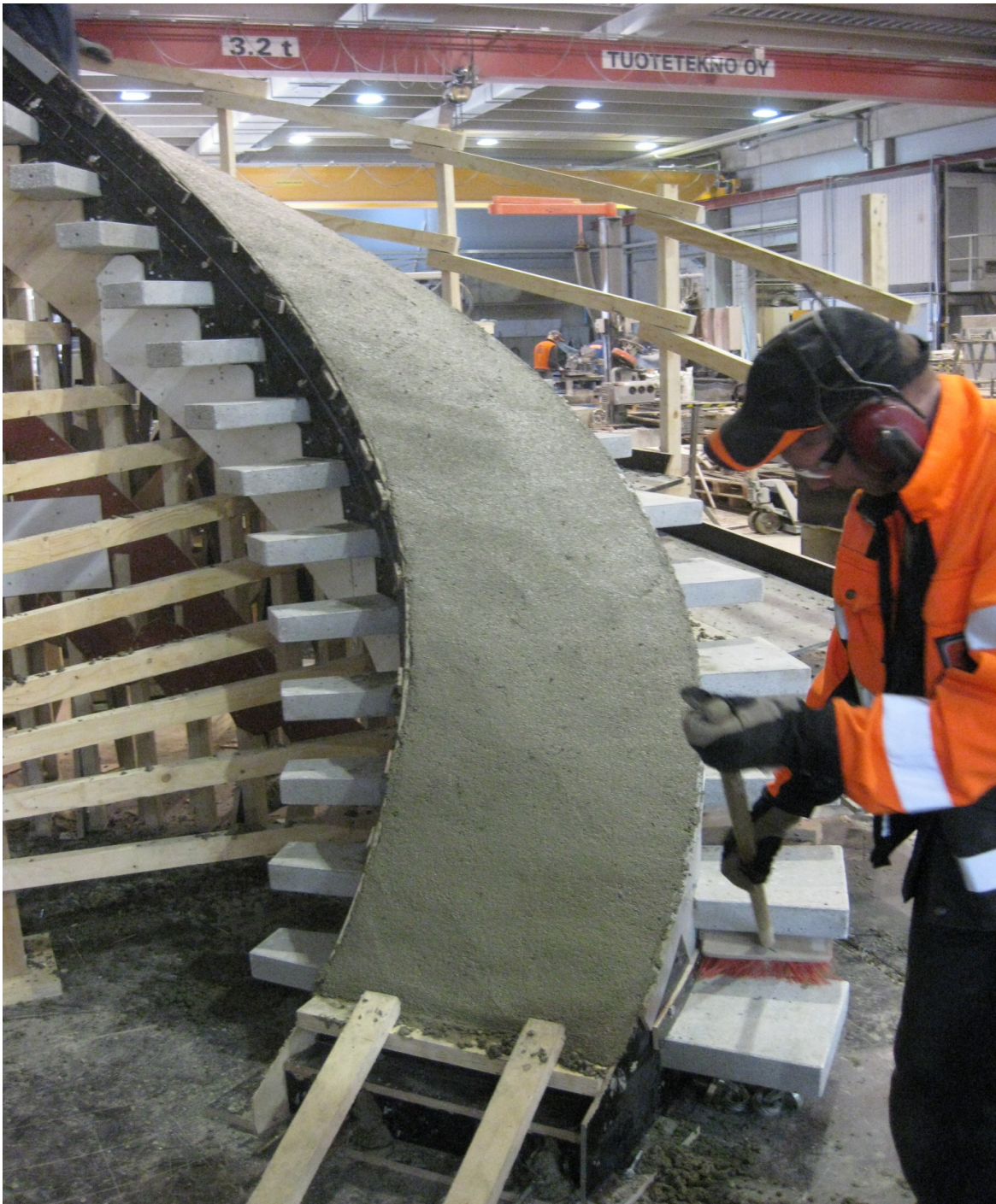
Kuva 15. Ennen teräshiertoa on aikaa puhdistaa askelmien alapinnat ja työtasot betoniroskeista. (kuva: Sami Hellberg )
