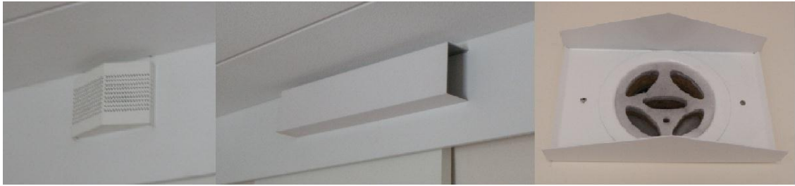
Kuva 10. Järjestys vasemmalta: STH-tuloilmalaite, STH:n päälle rakennettu pelti, tuloilmakanaavaan asennettu vaimennin.
