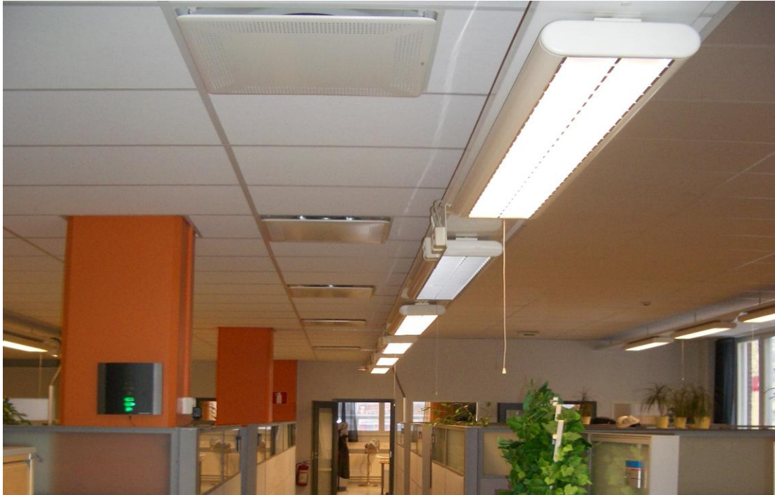
Kuva 21 Katon rajaan asennettuja tuloilman päätelaitteita.
