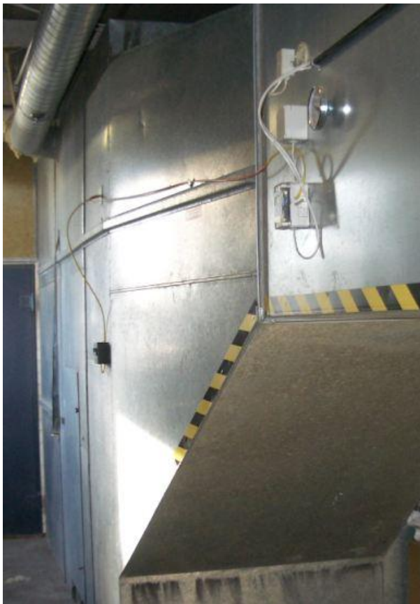
Kuva 12 Lämpötila- ja paineanturit tuloilmakammiossa.
