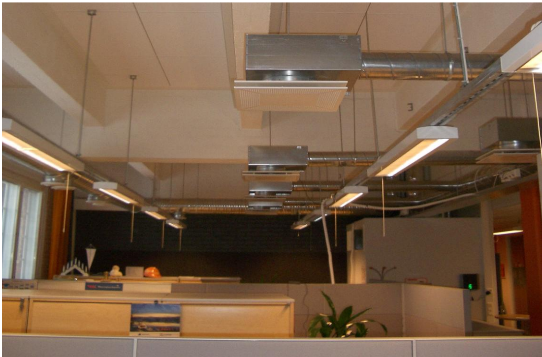
Kuva 22 Vapaa-asennettuja tuloilman päätelaitteita.
