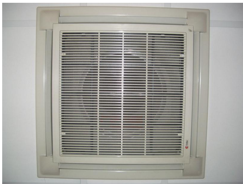
Kuva 15 Chiller puhallinkonvektori sisäilman jäähdyttämiseen.
