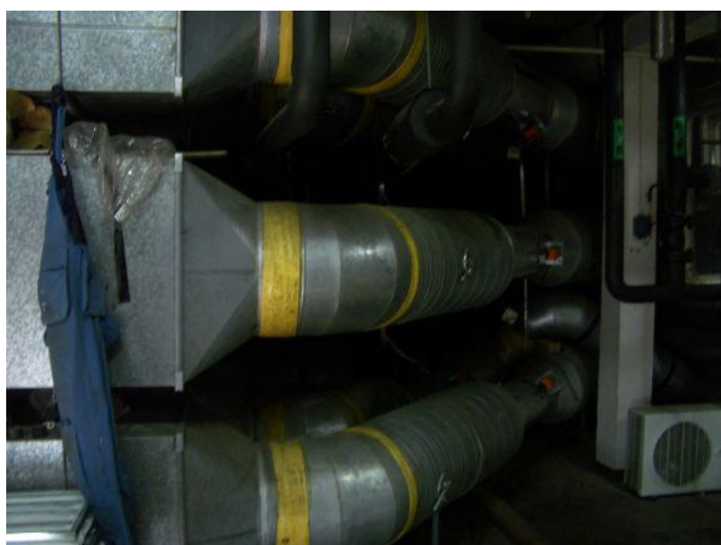
Kuva 14 Vyöhykekohtaiset tuloilmakanavat säätöpelleillä.
