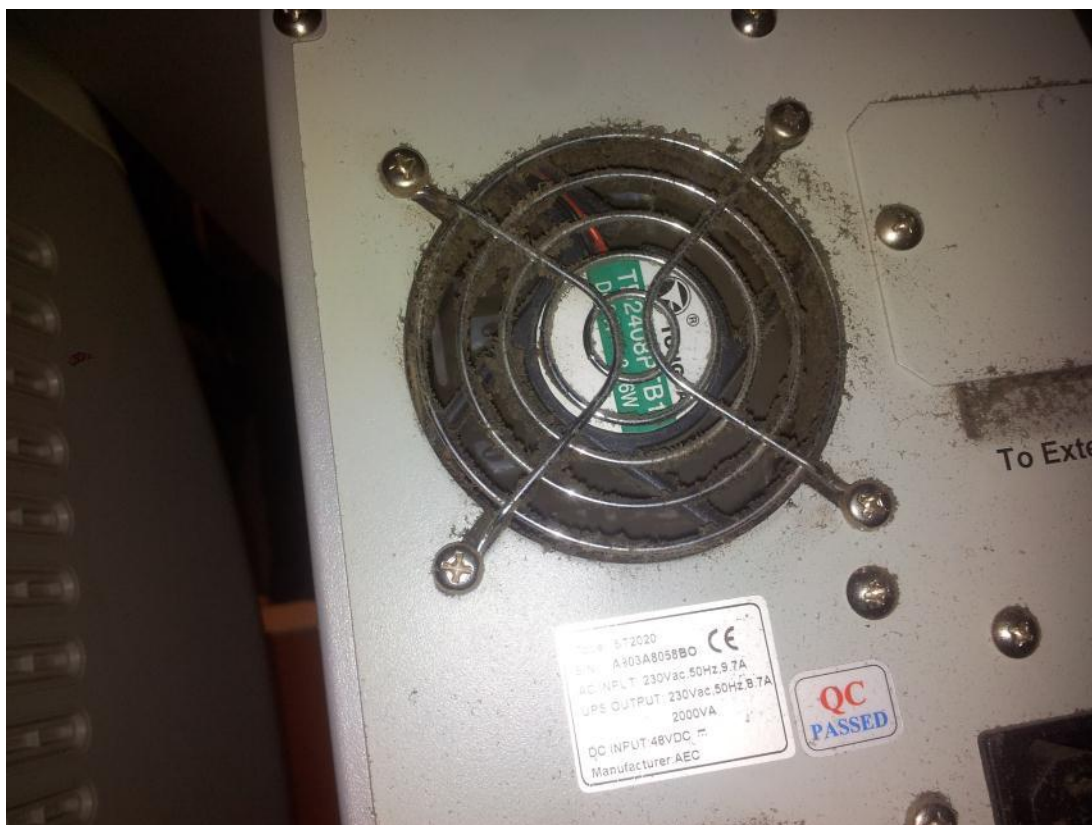
Kuva 8. Pöly on lähes tukkinut ilmatiet.
