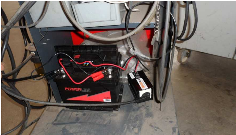
Kuva 1: Pakokaasuanalysaattoriin asennetut akku ja invertteri
