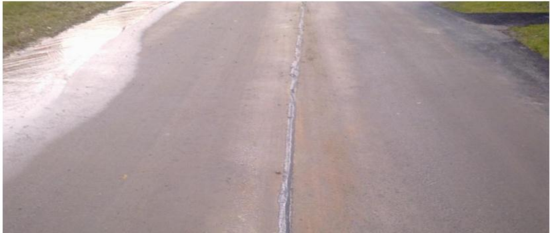
KUVA 3. Kuumalla bitumimassalla paikattu mikro-ojitus. Valokuva Petteri Sikanen 2011.
