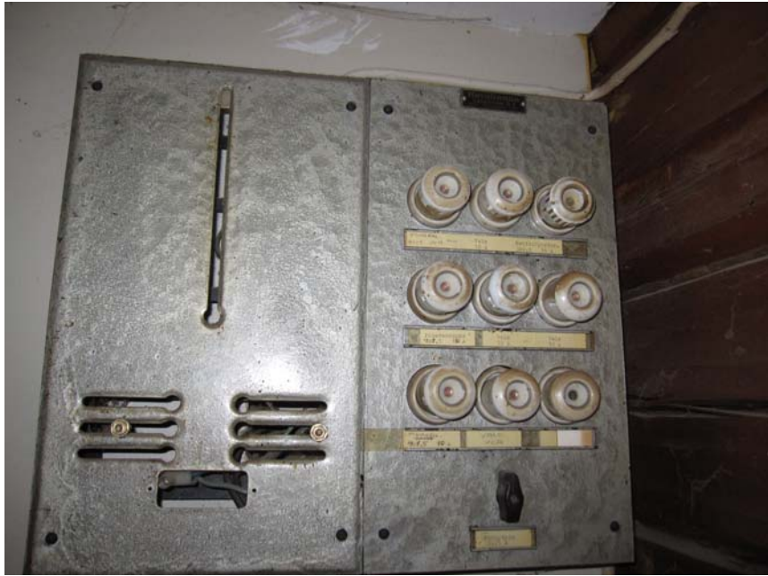
KUVA 27 Rakennuksen vanha, edelleen käytössä oleva sähkökeskus
