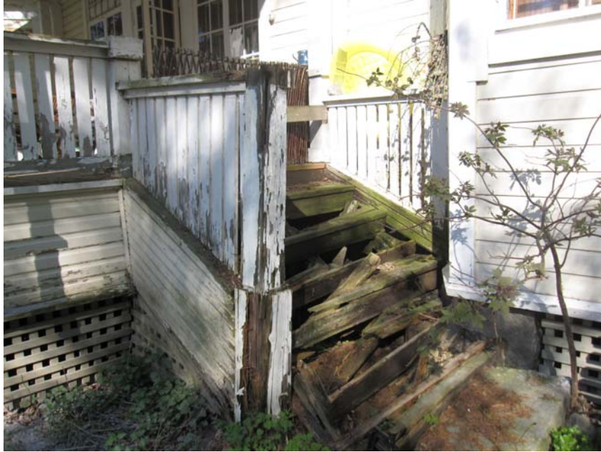
KUVA 23 Täysin lahonneet portaat rakennuksen takakuistilta
