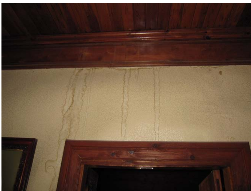
Kuva 6: Pinkopahvin alle muodostunut kosteusvaurio
