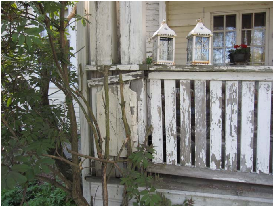
KUVA 24: Etukuistin vaurioituneet kaiteet
