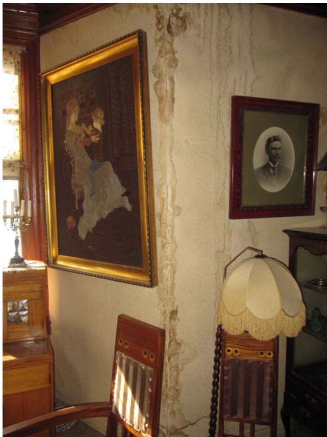
Kuva 5: Pinkopahvin alle muodostunut kosteusvaurio
