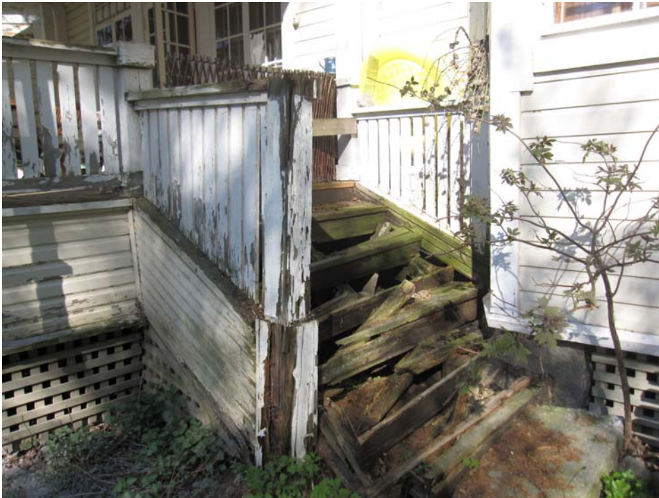
KUVA 26: Takakuistin lahonneet rappuset
