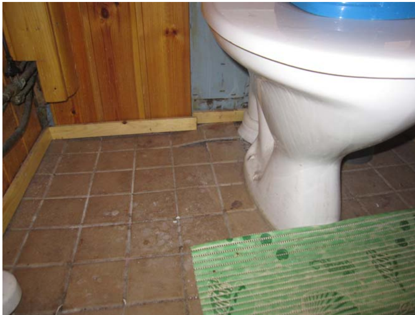
KUVA 12 Wc:n irronneita lattialaattoja
