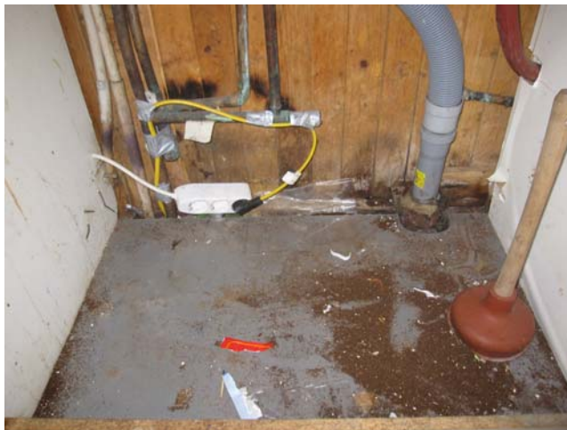
KUVA 18: Allaskaapissa sijaitseva viemärin läpivienti
