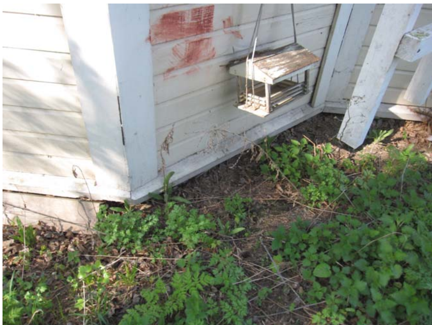
KUVA 21: Alapohjan tuuletusrako kapeimmillaan
