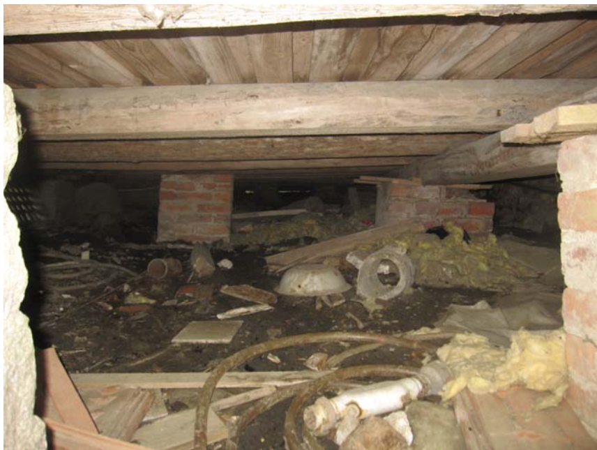
KUVA 20: Alapohjassa lojuvaa jätettä
