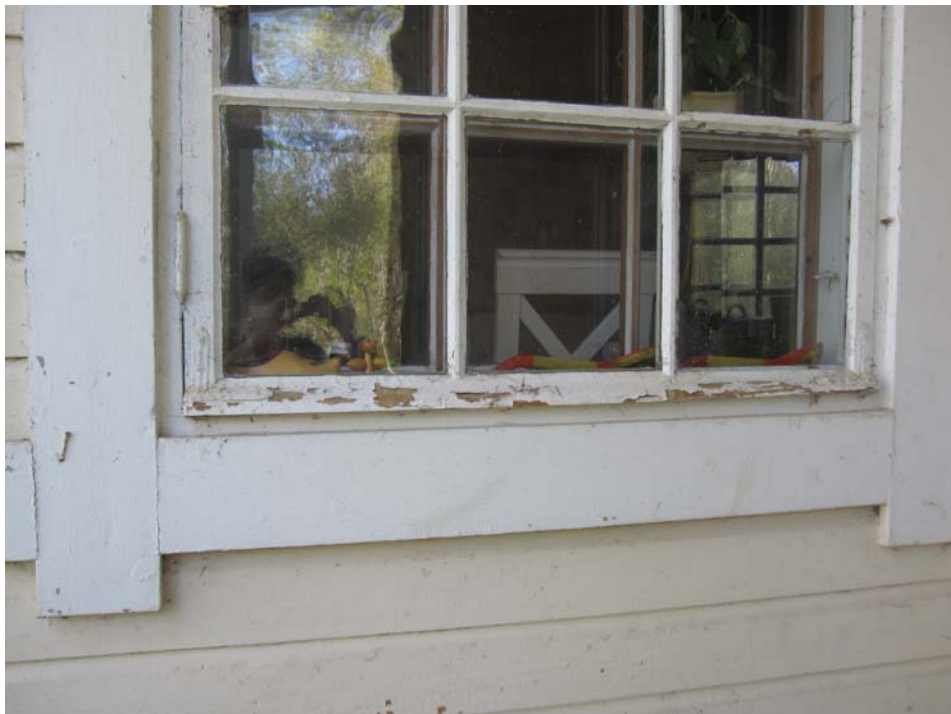
KUVA 27: Makuuhuoneen ikkunan rapistunut maalipinta
