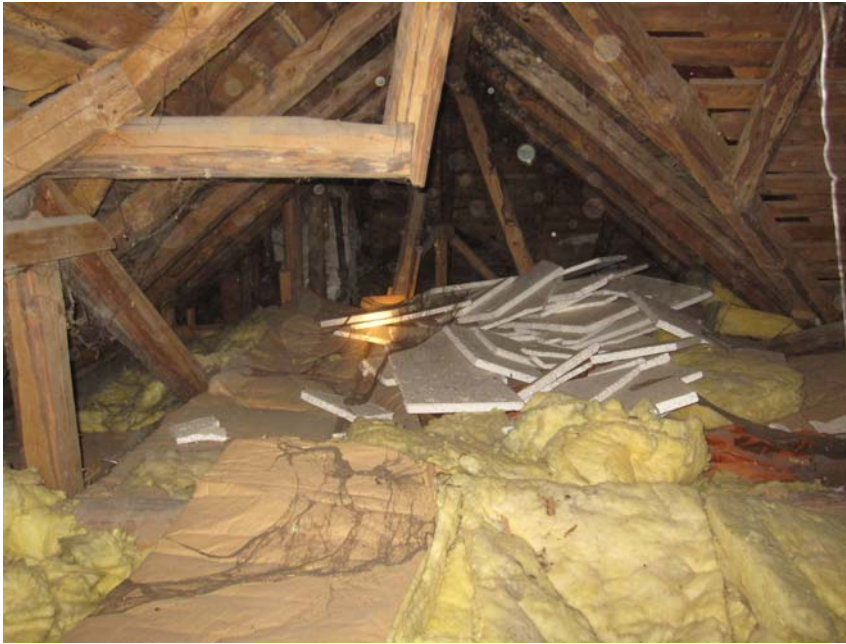
KUVA 3: Epämääräistä jätettä yläpohjassa
