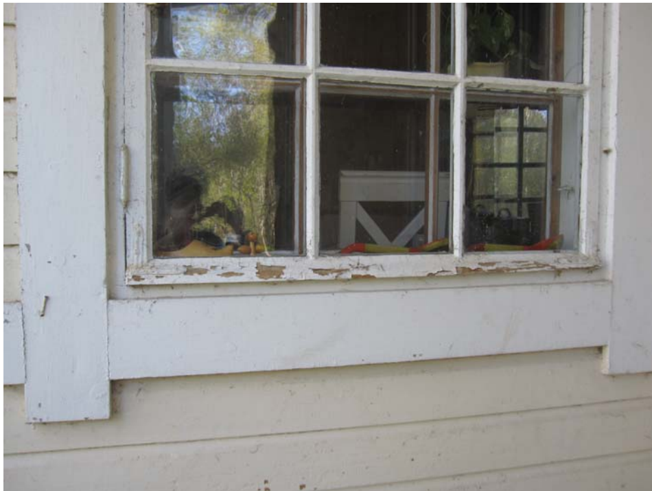
KUVA 25 Ikkunan huonokuntoista maalipintaa
