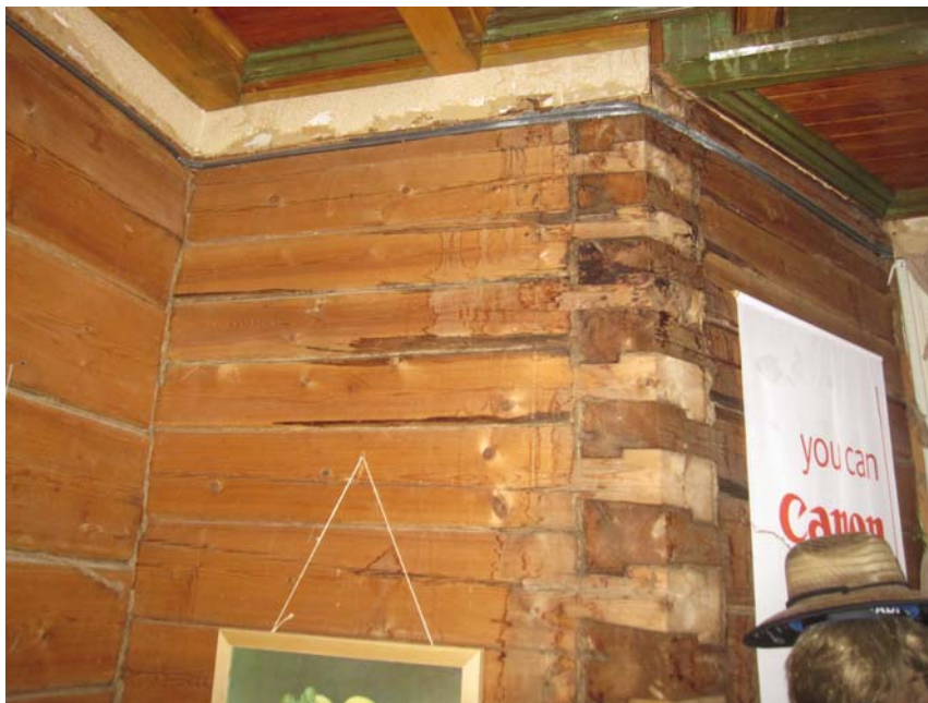
KUVA 4: Katon jiiristä päässeen veden aiheuttama valumajälki
