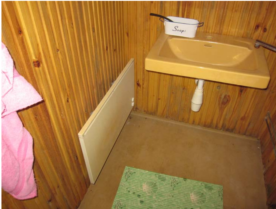
KUVA 33: Suihkutilan sähköpatteri määräysten vastaisesti roiskealueella
