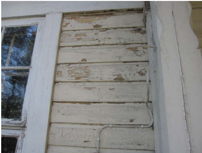
KUVA 7: Ulkoseinän rapistunut ja irtoileva maalipinta
