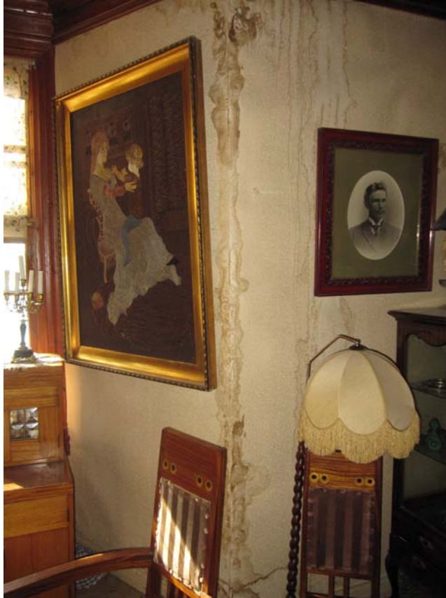
KUVA 4 Kosteuden aiheuttamaa tummentumaa pinkopahvissa
