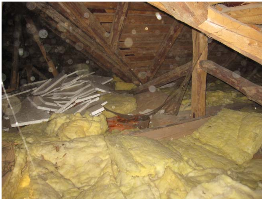
KUVA 2: Yläpohjan runkorakenteita ja Epämääräistä jätettä
