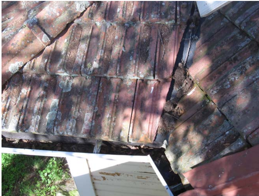
KUVA 20 Räystäsiin kerääntynyttä orgaanista jätettä
