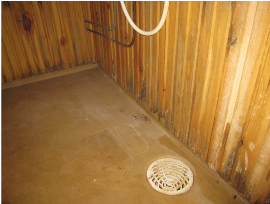
KUVA 9 Suihkutilan vaurioituneet seinäpaneelit sekä lattialle lammikoitunutta vettä
