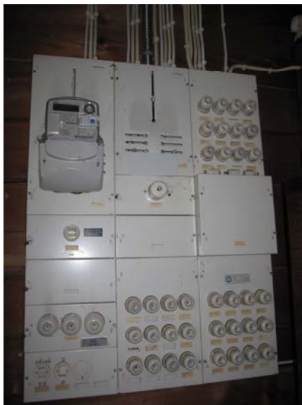
KUVA 30: Vuonna 1972 asennettu sähkökeskus eteisessä
