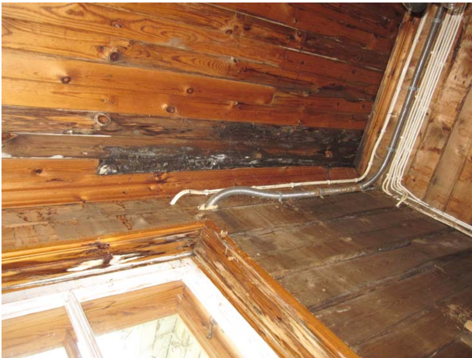
KUVA 14: Vesikatteen murtojiirin vuodon aiheuttama kosteusvaurio yläpohjan alapinnassa rakennuksen eteisessä
