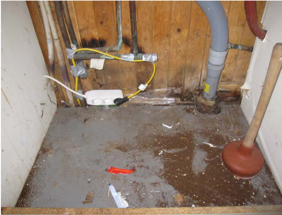
KUVA 15 Kosteusvaurioita keittiön allaskaapissa viemärin läpiviennin ympärillä
