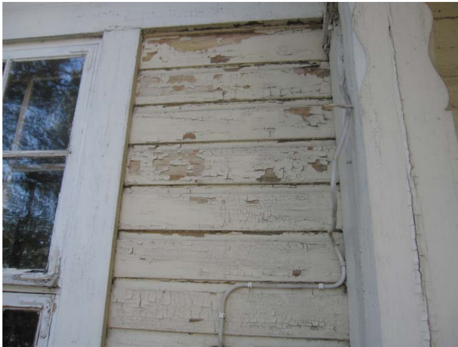
KUVA 5 Ulkoseinän hilseilevä maalipinta
