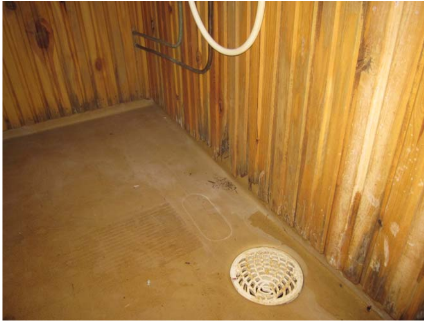
KUVA 16: Suihkutilan vaurioitunut panelointi
