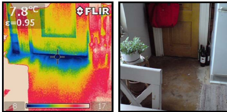
KUVA 8 Lämpövuotoa keittiön oven alta
