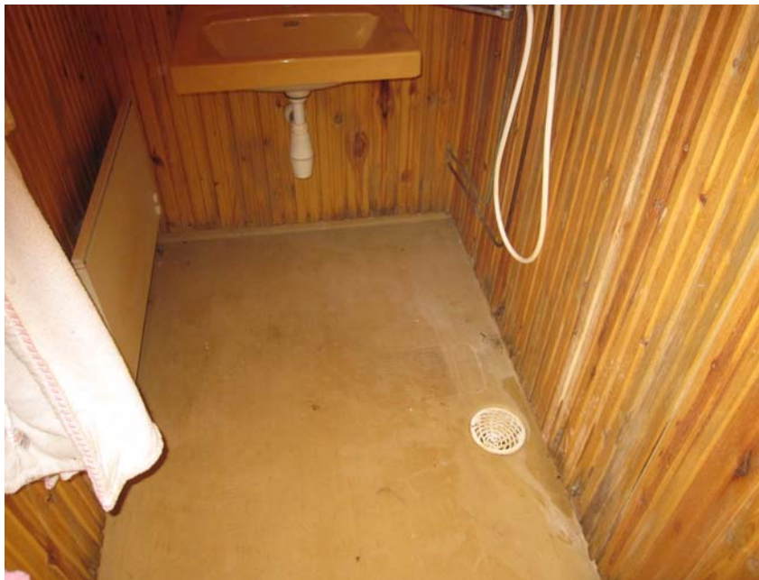
KUVA 15: Suihkutilan lattialle lammikoitunut vesi
