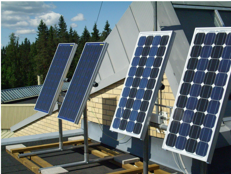
Kuva 22. Aurinkopaneelijärjestelmä Savonia-amk:n Varkauden yksikön katolla.
