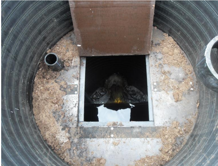
Kuva 19. Lähtevän veden mittauskaivo. (Kuva: Merja Koponen.)
