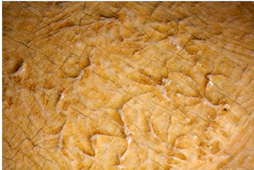
Kuva 17. Kuvassa on havaittavissa maalikerrosten rypistymistä.
