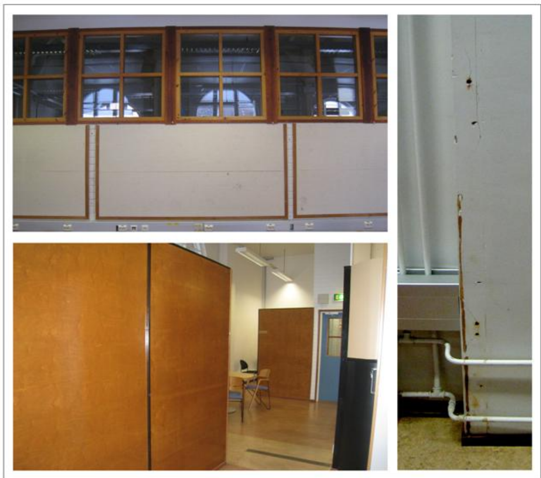
Kuva 14. Protomon tiloissa haluttiin päivittää puunvärisiä elementtejä valkoisen maalin avulla. Myös korjausta vaativat kohteet, kuten kulumat, huomioitiin maalaussuunnitelmassa. (Kemppainen, 2012.)
