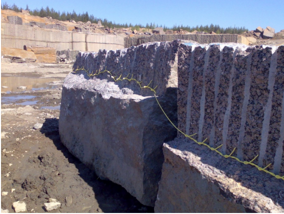
Kuva 9. Kiilattuja lohkareita, joissa lohkeaminen ei ole jatkunut pohjalle saakka. Loppuosaa on panostettu räjähtävällä tulilangalla.
