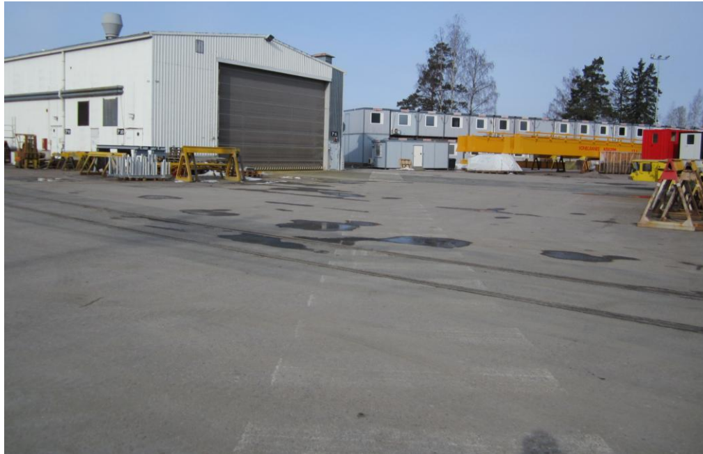
Kuva 15. Haalistuneita suojiamaalauksia tehdasalueella
