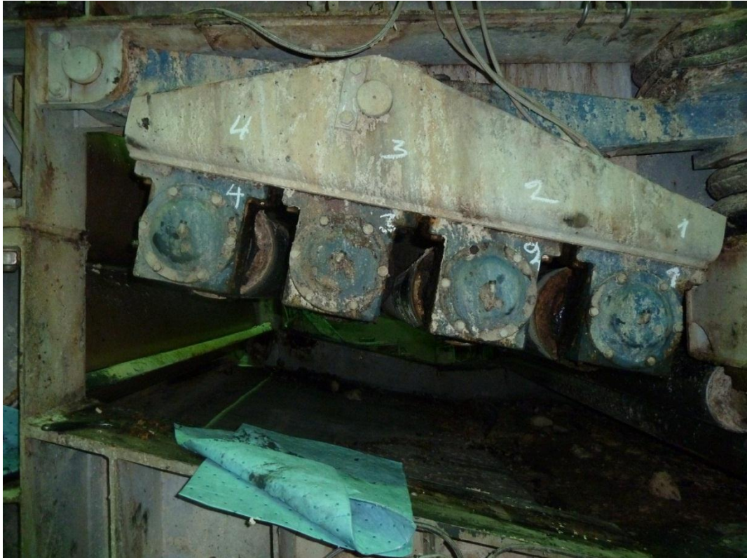
Kuva 6.9 Puristinosan alapuolen telat ja yläpuolen telojen kaavarit poistettu
