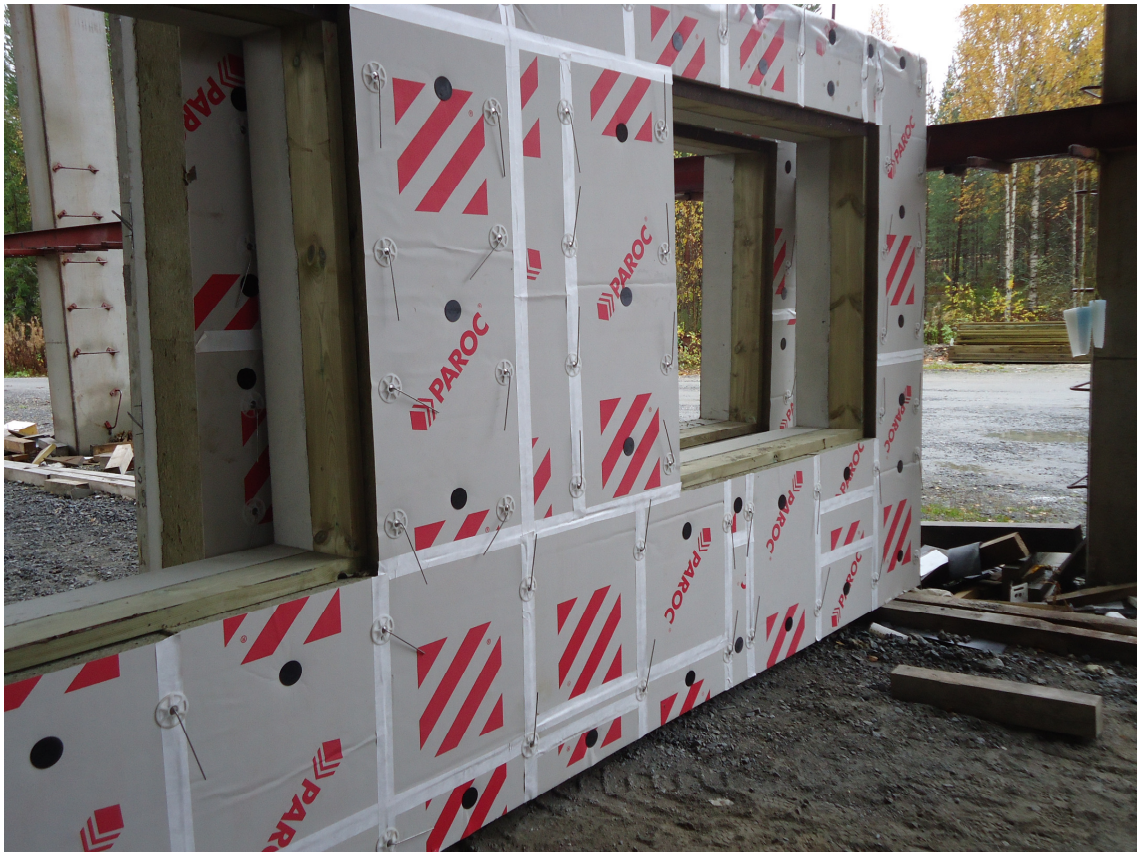
Kuva 8. Valmiita teräsbetoniseinäelementtejä eristyksineen elementtitehtaan välivarastossa.
