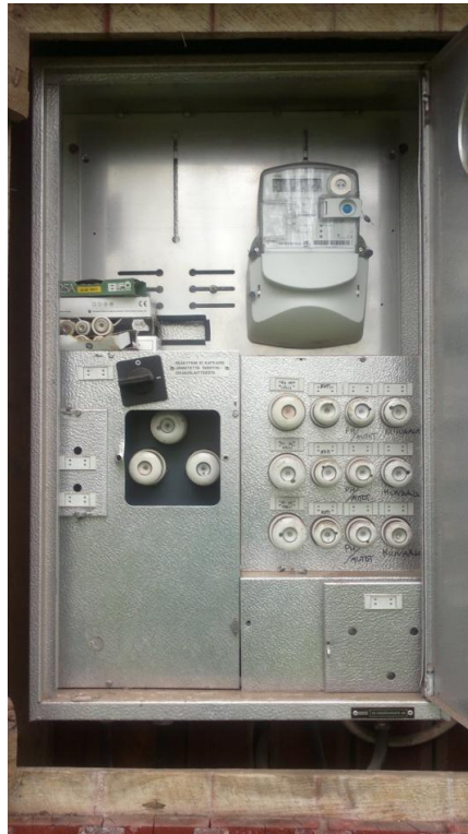
KUVIO 1. Vanha sähköpääkeskus
